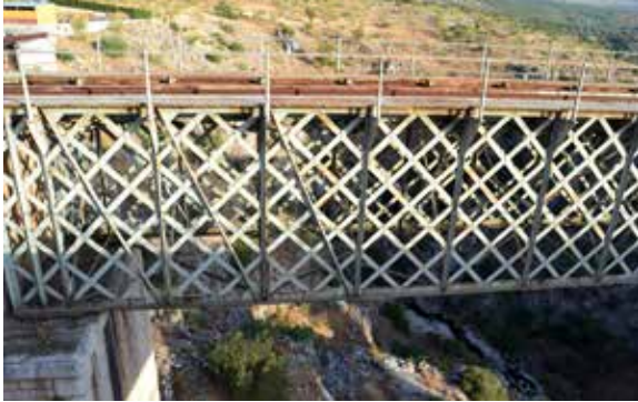
Figura 17. Detalle de la celosía con refuerzos a cortante y aparatos de apoyo del tramo metálico sobre los estribos. Viaducto del Barrancón, fotografía del autor
