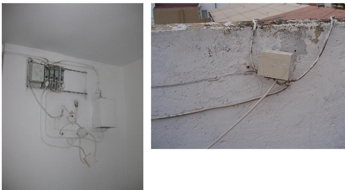
Figura 64. Instalaciones de suministro eléctrico (obtenida de Serrano Lanzarote 2016)
