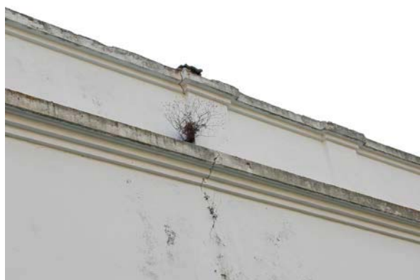
Figura 6: Grieta estructural y agentes bióticos.
