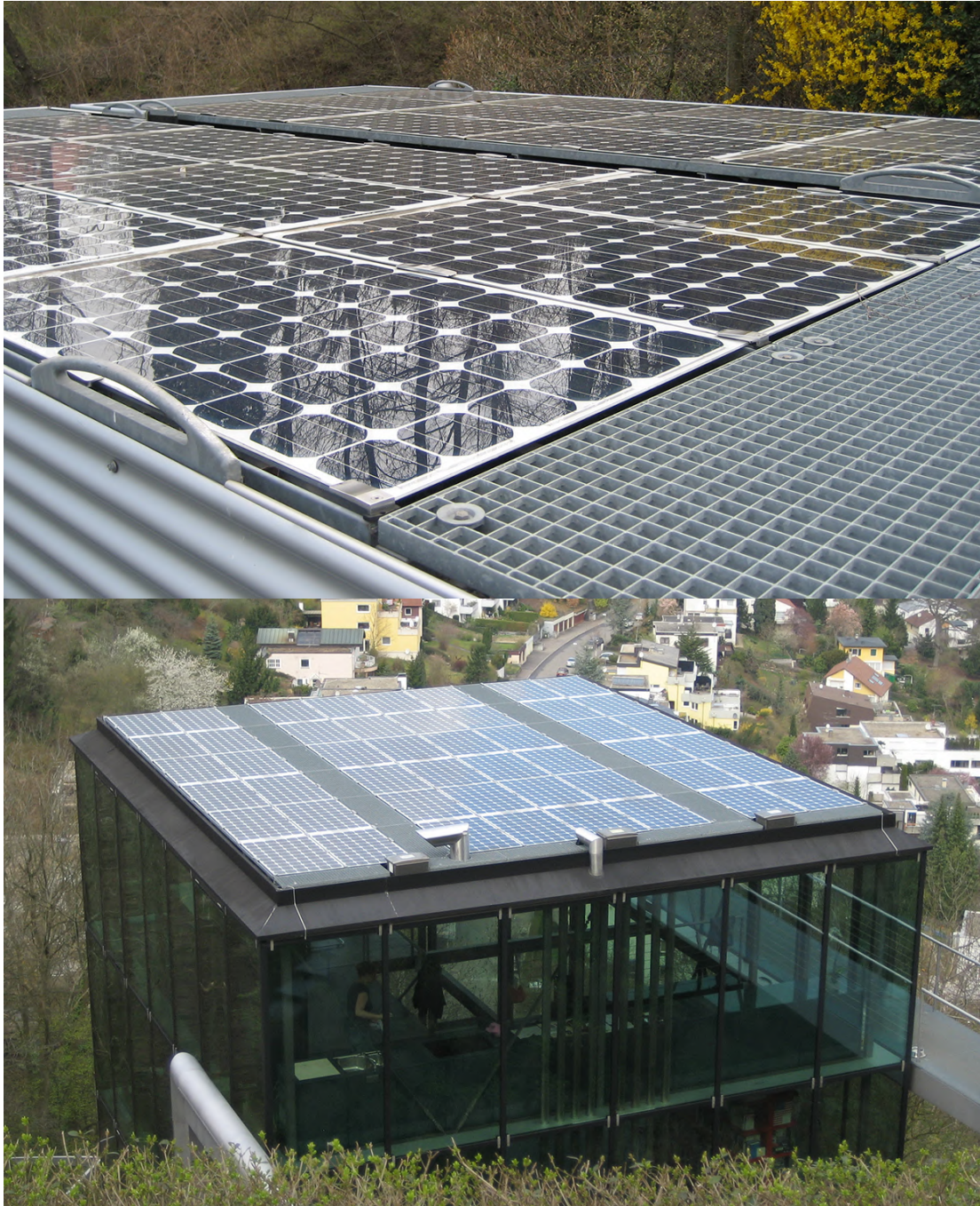
88 Detalle de placas Vista de cubierta con paneles fotovoltaicos. [Baumgartner 2016]
