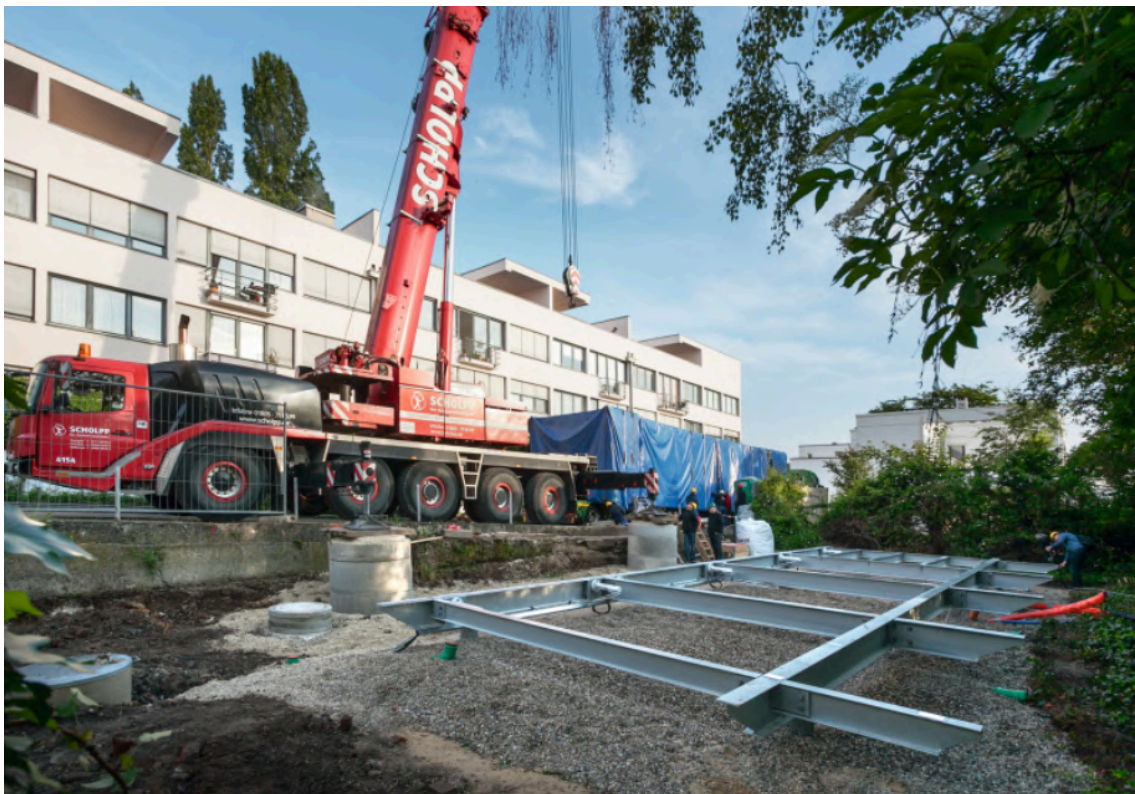
99 Montaje en taller de la B10. [DBZ] Transporte y posicionamiento en parcela. [ArchDaily] Preparación de la parcela para recibir la B10, detalle de la cimentación desmontable. [DBZ]
