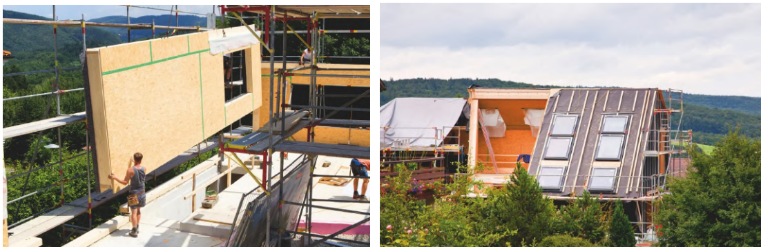
80 Montaje piezas prefabricadas de la fachada y vista de la cubierta en construcción. [CDN archilovers]
