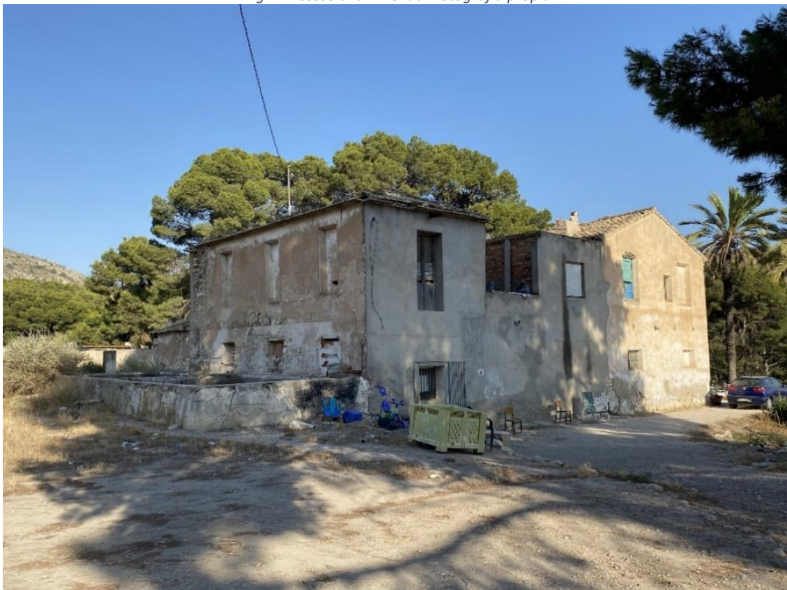
Img.8. Evidente grado de deterioro en toda la casa. Fotografía propia
