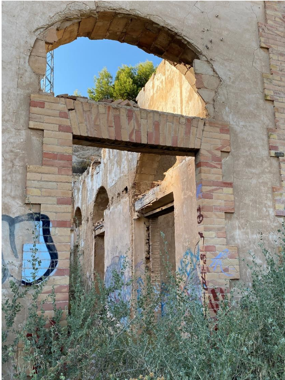
Img.21. Huecos con desprendimientos. Fotografía propia
