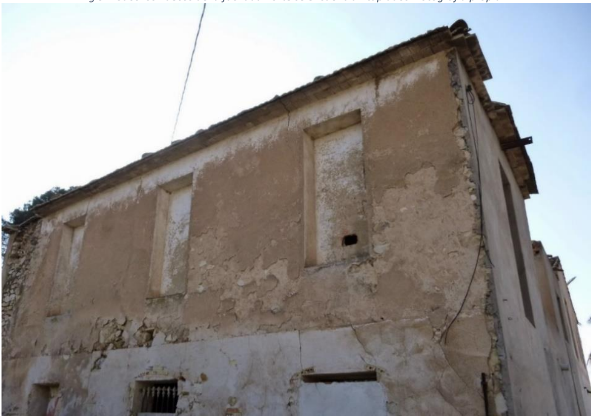
Img.10. Falta total de cuidados en las fachadas. Amigos por la Recuperación del Castillo de Elda
