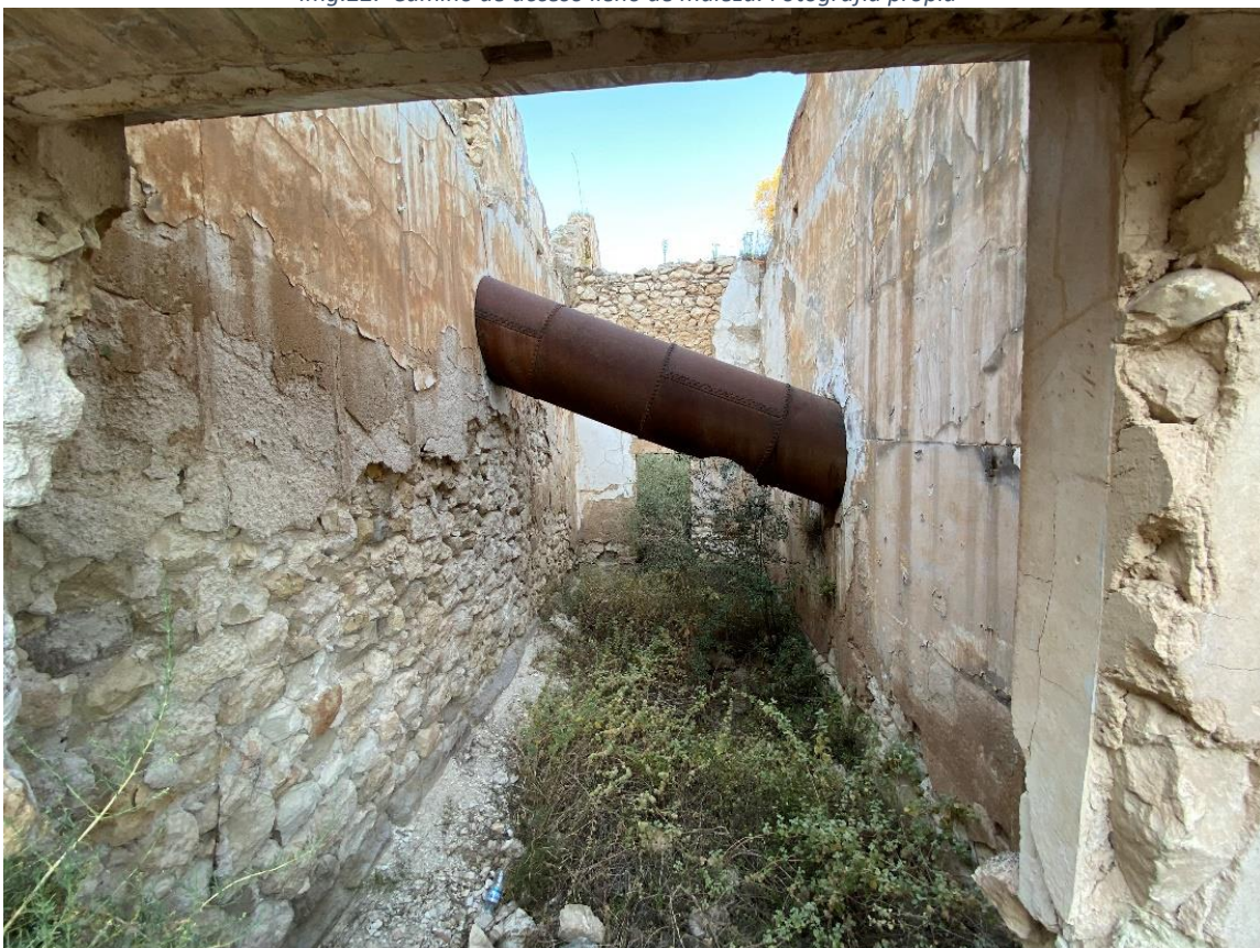
Img.23. Tubería que llevaba el agua desde la acequia totalmente oxidada. Fotografía propia
