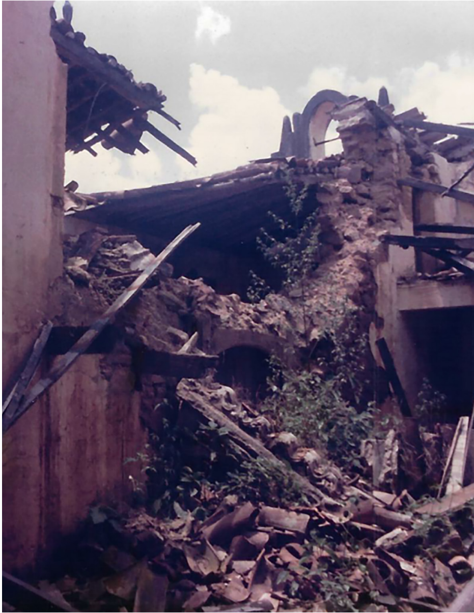
Figura 99. Muro de la nave en el lado de la epístola colapsado con los escombros de la cubierta. Tomado de Almeida, 1990.
