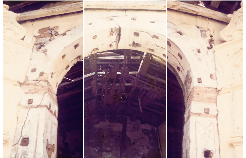
Figura 105. Grietas formadas en el arco crucero. Montaje hecha por el autor a partir de fotografías tomadas de Almeida, 1990.
