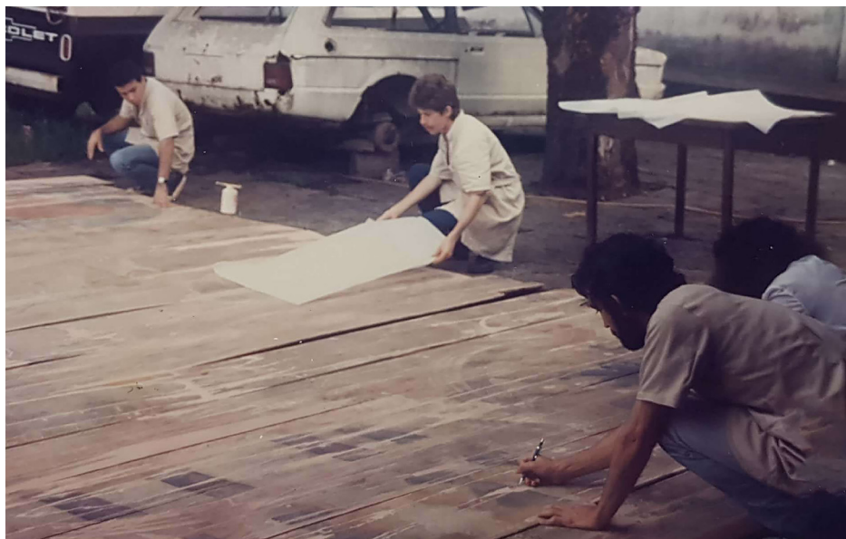
Figura 120. Recuperación del techumbre de la nave. Tomado de la colección del IPHAN, 1991.
