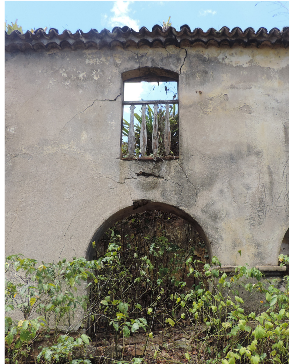
Figura 102. Fisuras en el arco del pasillo lateral del lado del evangelio y en las ventana superior de la galería. Tomado por el autor, 2020.
