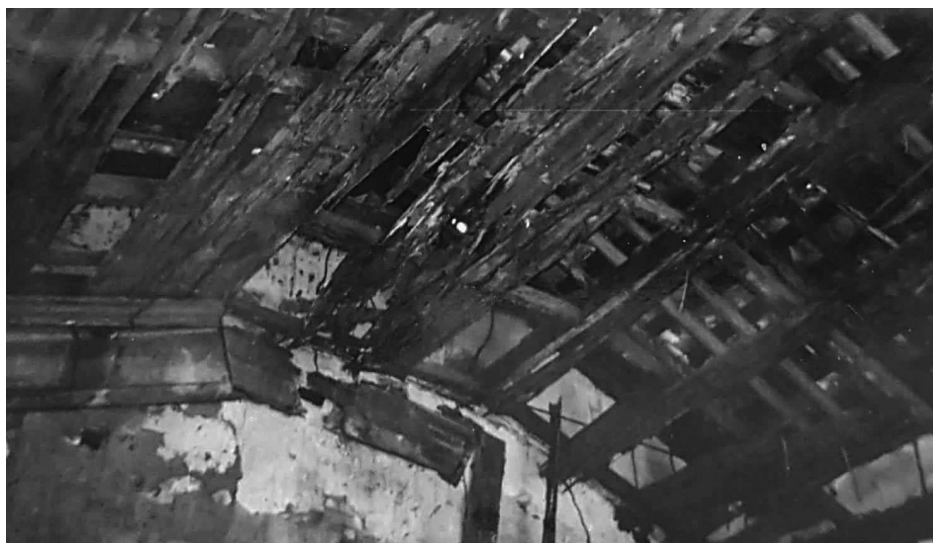
Figura 121. Techumbre de la capilla mor degradado por la acción de termitas. Tomado de la colección del IPHAN, 1996- 1997.
