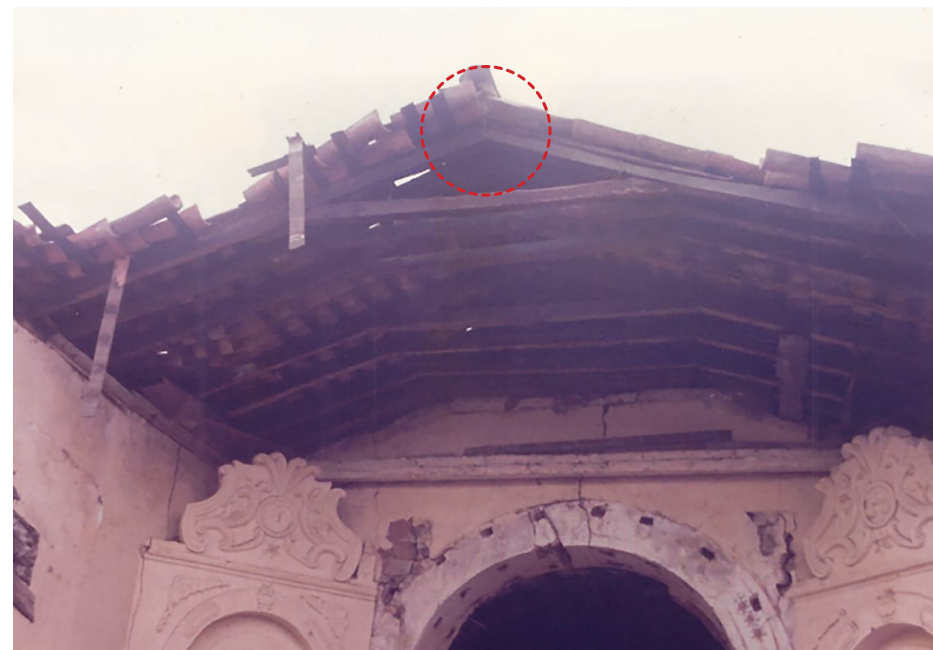
Figura 83. Vista de lo que sobró del tejado colapsado sobre los altares colaterales de la nave del Mosteirinho de São Francisco . Modificado por el autor a partir de Almeida, 1990.
