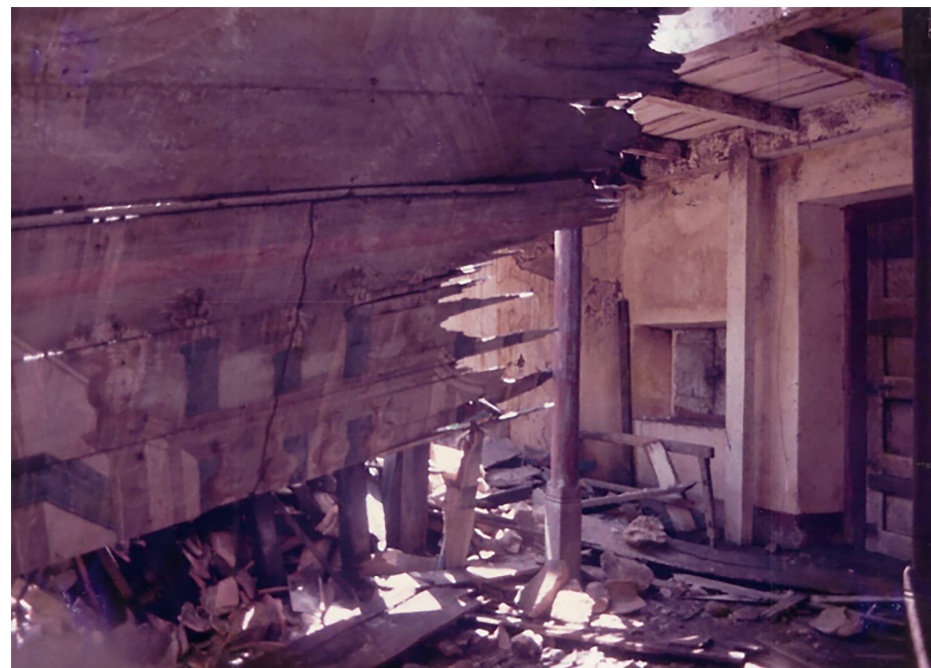
Figura 118. Techumbre de la nave colapsado con las tablas rompidos irregularmente. Tomado de Almeida, 1990.
