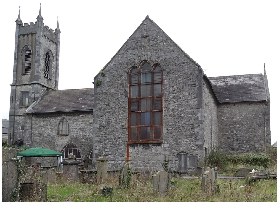
Figura 12. Estado de conservación de Saint Mary's Church antes de la conversión a museo (Anónimo, 2012). Tomada de sitio web Historic Graves, 2021.
