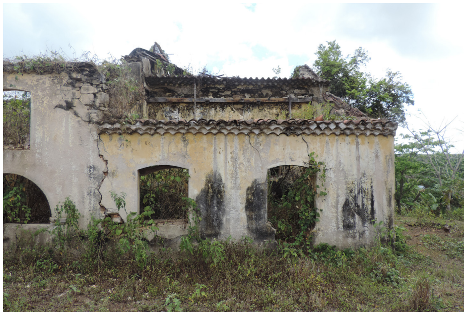
Figura 117. Cobertura de la sala capitular colapsada. Tomado por el autor, 2020.
