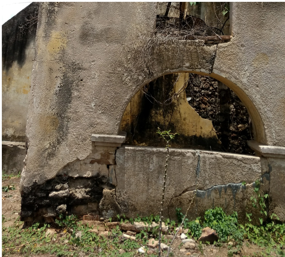
Figura 107. Grieta en diagonal (arqueada) abajo del primero arco del muro externo del pasillo lateral del lado de la epístola. Tomado por el autor, 2020.
