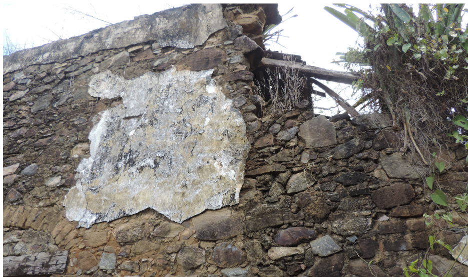
Figura 96. Desprendimiento de los enlucidos en el muro del arco crucero. Tomado por el autor, 2020.
