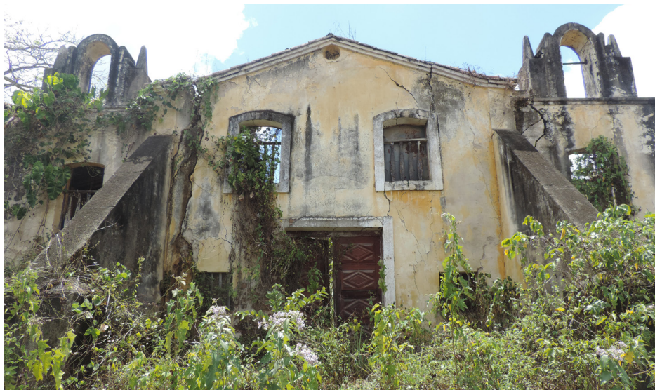
Figura 104. Grieta en la fachada principal causada por la inclinación del muro de la nave en el lado del evangelio. Tomado por el autor, 2020.
