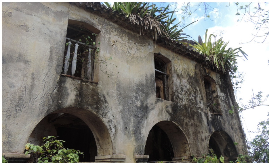
Figura 97. Patologías en el muro del pasillo lateral del lado del evangelio. Tomado por el autor, 2020.
