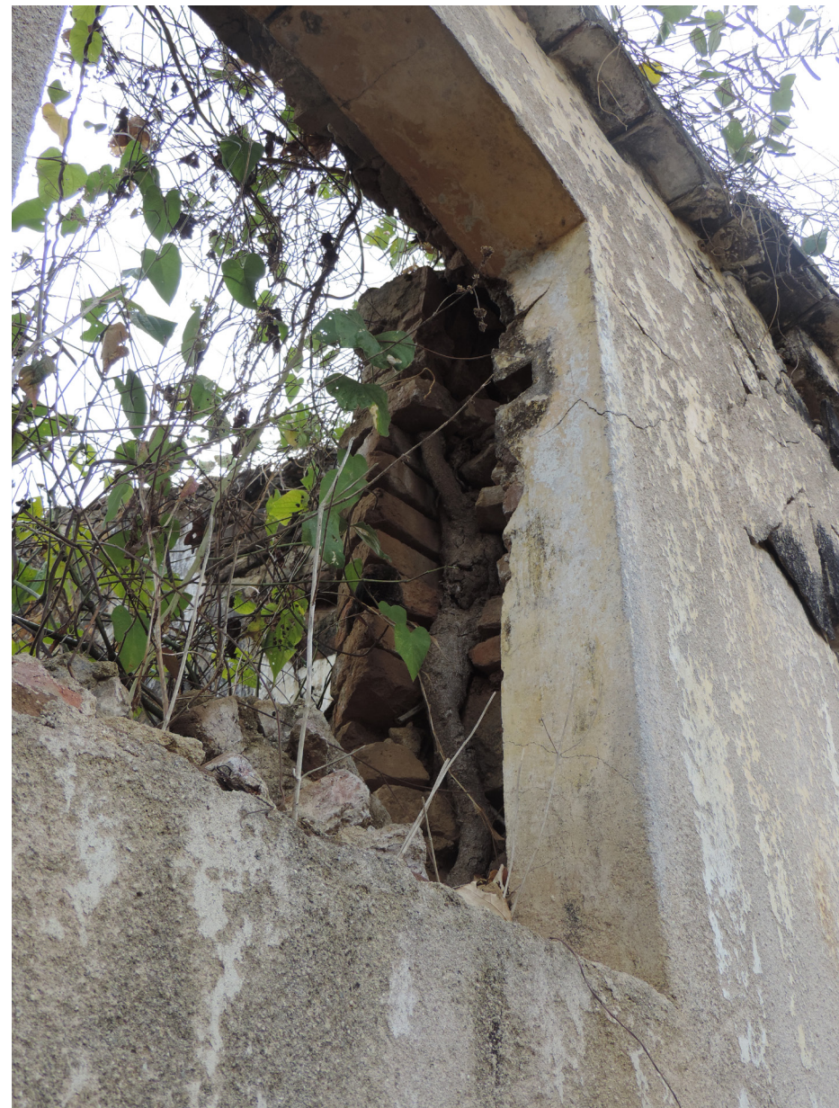
Figura 107. Raíces en las grietas. Tomado por el autor, 2020.
