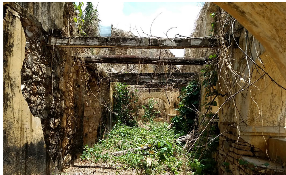
Figura 110. Situación actual del suelo del primero piso del lado de la epístola y del suelo de pavimento terreo cubierto por hierbas dañinas y escombros. Tomado de la colección del IPHAN, 2019.
