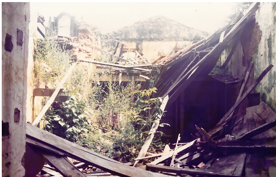
Figura 114. Cubierta de la nave colapsada. Tomado de Almeida, 1990.
