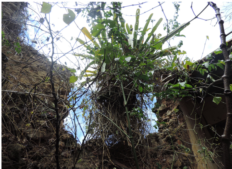
Figura 109. Parte del muro de la nave en el lado del evangelio colapsada. Tomado por el autor, 2020.
