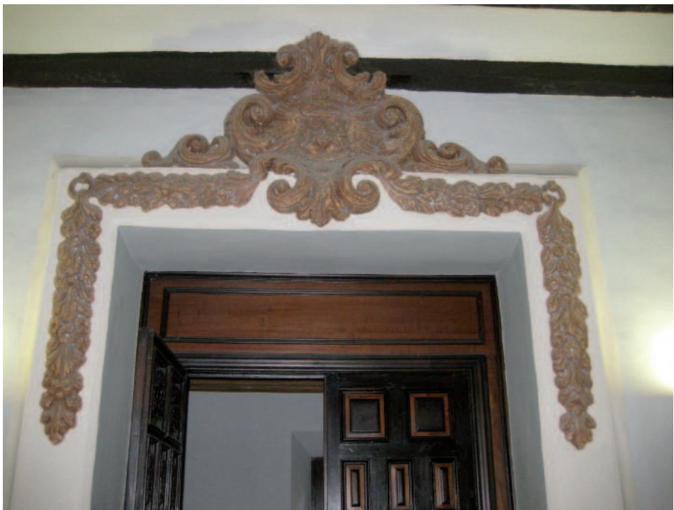
156.- Colegio de Segorbe. Detalle de la puerta de acceso a la primera planta del claustro
