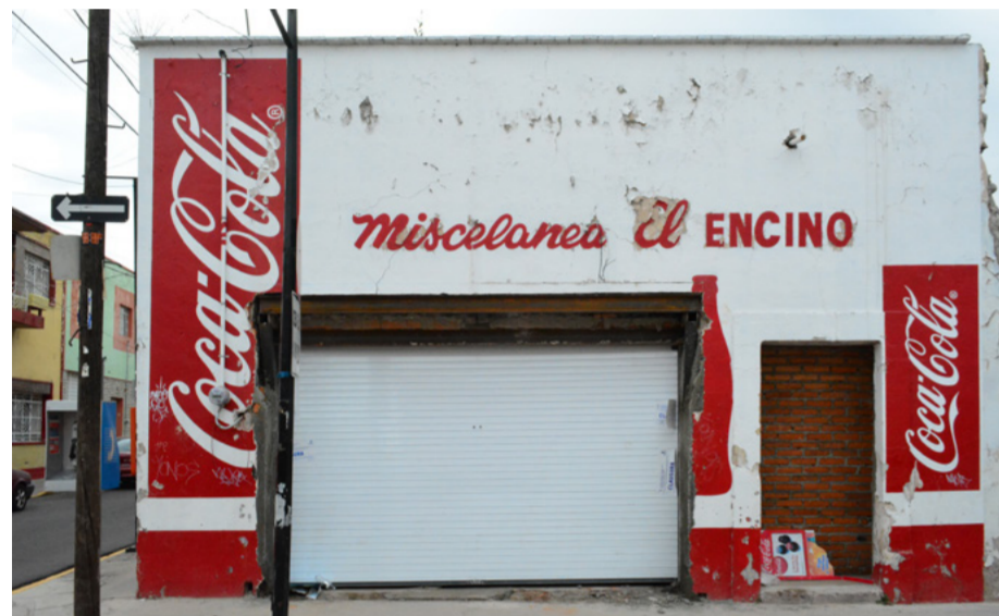
Figura 8.16 Conversión de dos vanos de ventana en uno sólo para apertura de local comercial, Leona Vicario 127, 2015. La pintura también es un elemento que agrede el entorno urbano, disminuyendo la capacidad de los inmuebles de transmitir su carácter tradicional.
