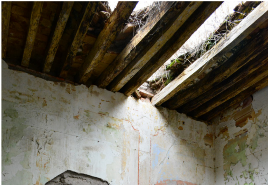
Figura 6.10 Colapso parcial de cubierta, Nieto 402 [Inmueble perdido], 2016.
