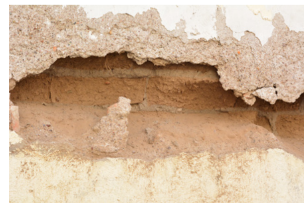
Figura 6.5 Pérdida de recubrimiento y reducción de sección resistente en cuerpo de muro de adobe derivado de humedad capilar por ascensión y recubrimiento inferior con mortero de cemento, casa habitación en abandono, Aguascalientes, 2017.
