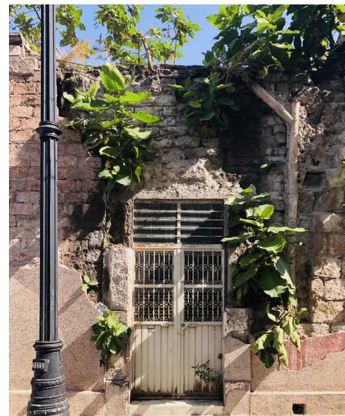
Figura 6.23 Abandono y proceso de ruina de un edificio, Allende 207, 2020.
