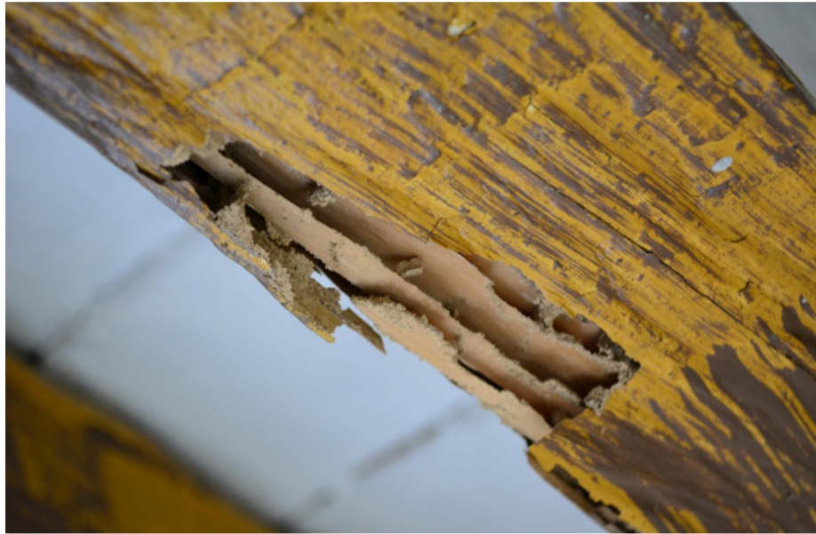
Figura 6.8 Ataque de xilófagos en viga de madera, Allende 333 [Inmueble perdido], 2015. La capa de pintura genera un ambiente propicio para la proliferación de las termitas.
