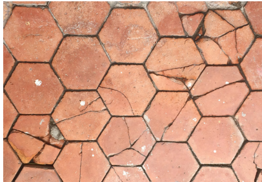
Figura 6.11 Fracturas en piso de loseta de barro, Venaderos, 2017
