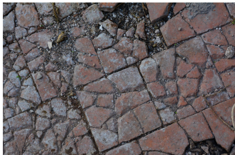
Figura 6.13 Fracturas en piso de loseta de barro, 16 de Septiembre, 2017
