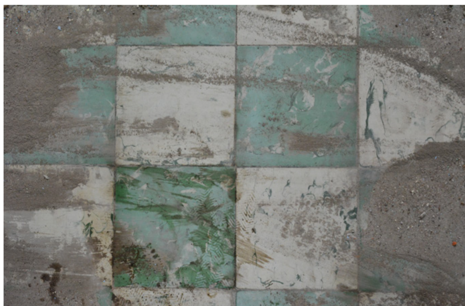
Figura 6.12 Oscurecimiento y pérdida de brillo en piso de mosaico de pasta, Nieto 402 [Inmueble perdido], 2015
