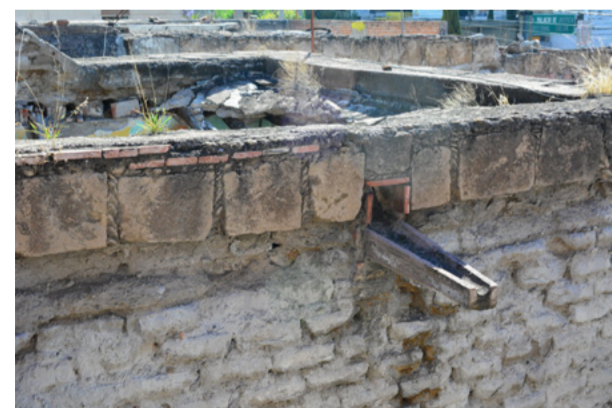
Figura 6.4 Pérdida de recubrimiento, erosión y disgregación de adobe por acción del viento y lavado de lluvia; colapso de cubiertas al interior del inmueble; crecimiento de flora, casa habitación en abandono, Aguascalientes, 2015
