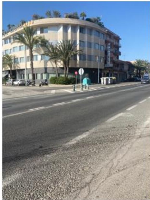
Imagen 3. Marcas viales borradas en el cruce C/ del Jardí y Avenida Íllice (Fuente: Elaboración propia)
