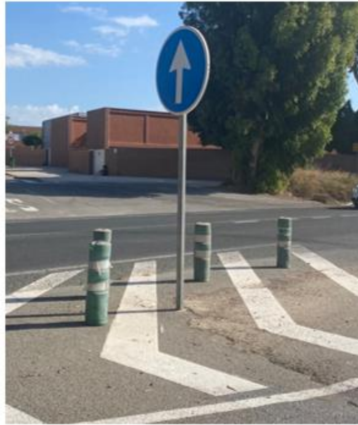
Imagen 5. Canalización de la intersección de C/ Limón en mal estado (Fuente: Elaboración propia)
