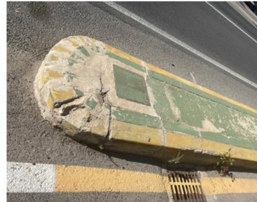
Imagen 8. Terciana en mal estado de la travesía(Fuente: Elaboración propia)
