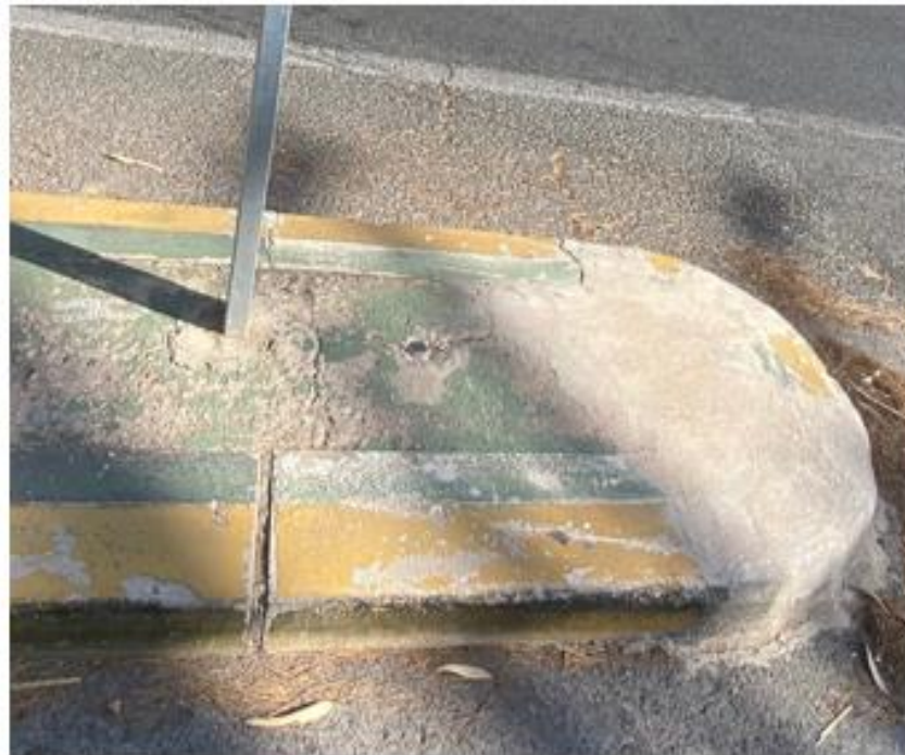
Imagen 7. Terciana en mal estado de la travesía(Fuente: Elaboración propia)
