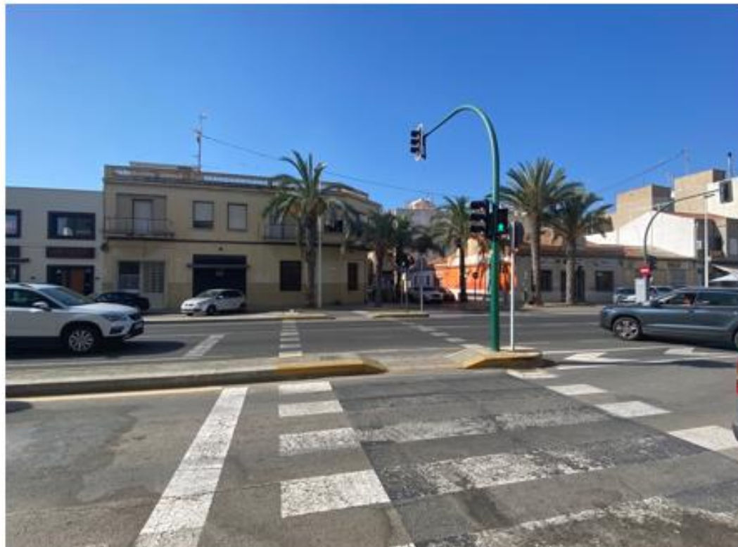
Imagen 15. Marcas viales en mal estado en la vía de servicio a la altura de C/ Río Vinalopó (Fuente: Elaboración propia)
