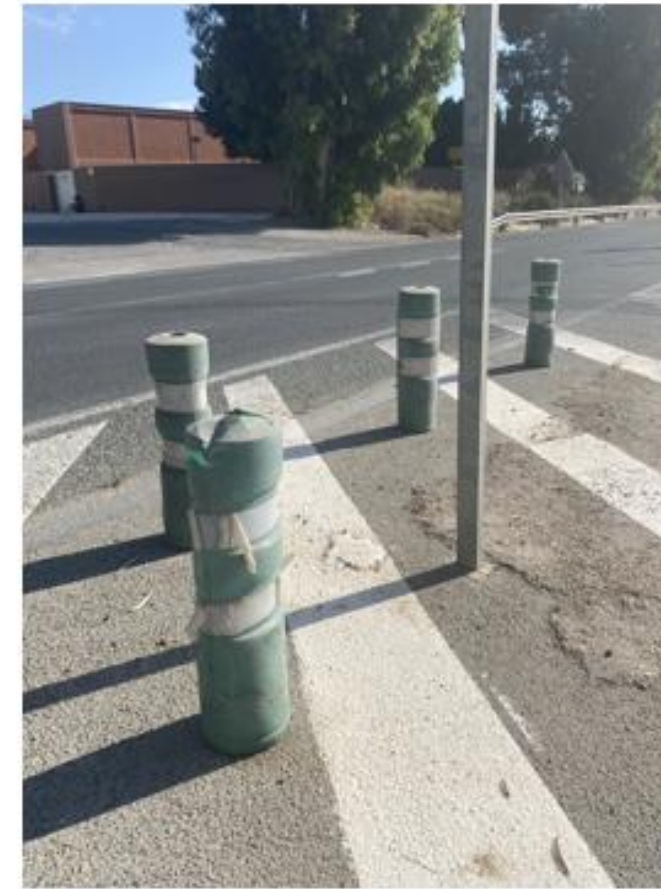
Imagen 6. Firme y balizas cilíndricas en mal estado (Fuente: Elaboración propia)
