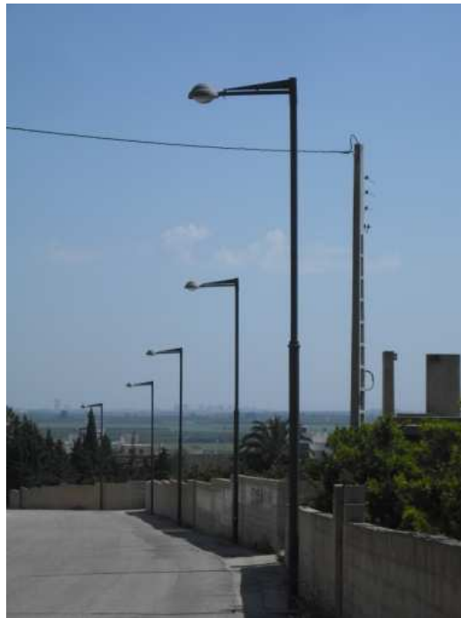
Figura 5.16. Fanals columna reflector a l'avinguda del senyor.
