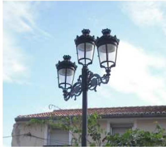
Figura 5.15. Columna poble amb tres fanals
