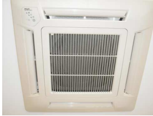
Figura 5.1. Split d'aire condicionat a l'Ajuntament
