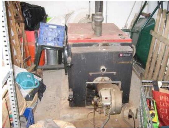
Figura 5.7. Caldera de gasoil instal·lada al Col·legi.
