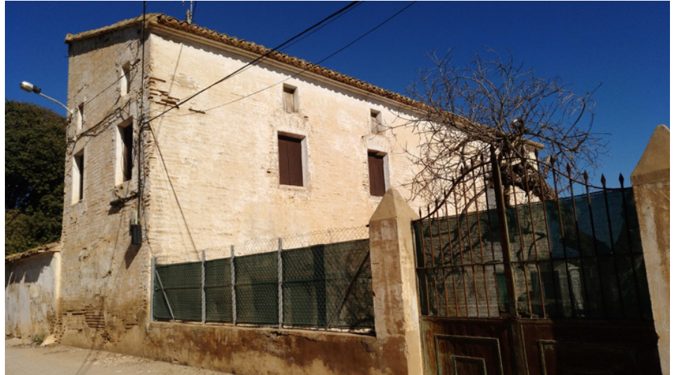
Figura 173. Imagen del estado actual del elemento 2. l'Alqueria LLeonard, 2019
