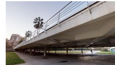
Daños por zonas
