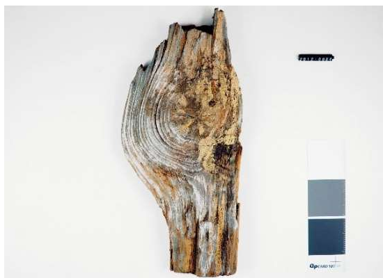
Figura 145. Madera que sufrió la acción de la intemperie 934
