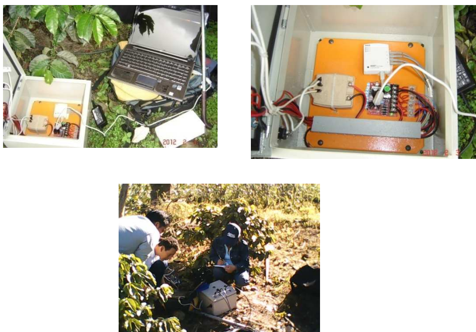
Figura 68. Tablero de control de caudalímetros y manómetros electrónicos
