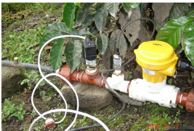
Figura 70. Caudalímetro y manómetros electrónicos
