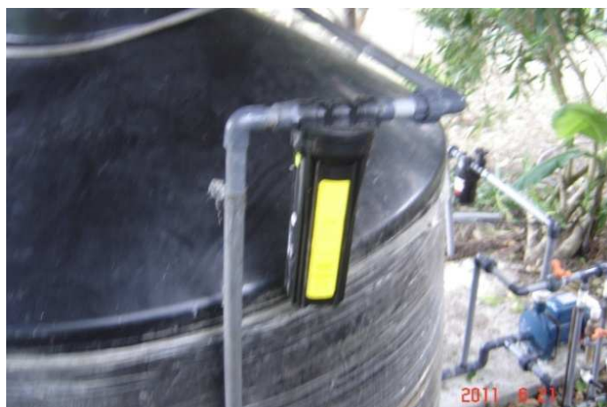
Figura 54. Tanque de reserva de 1.500 l.
