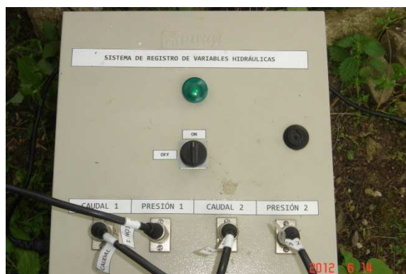
Figura 69. Tablero de control de variables hidráulicas
