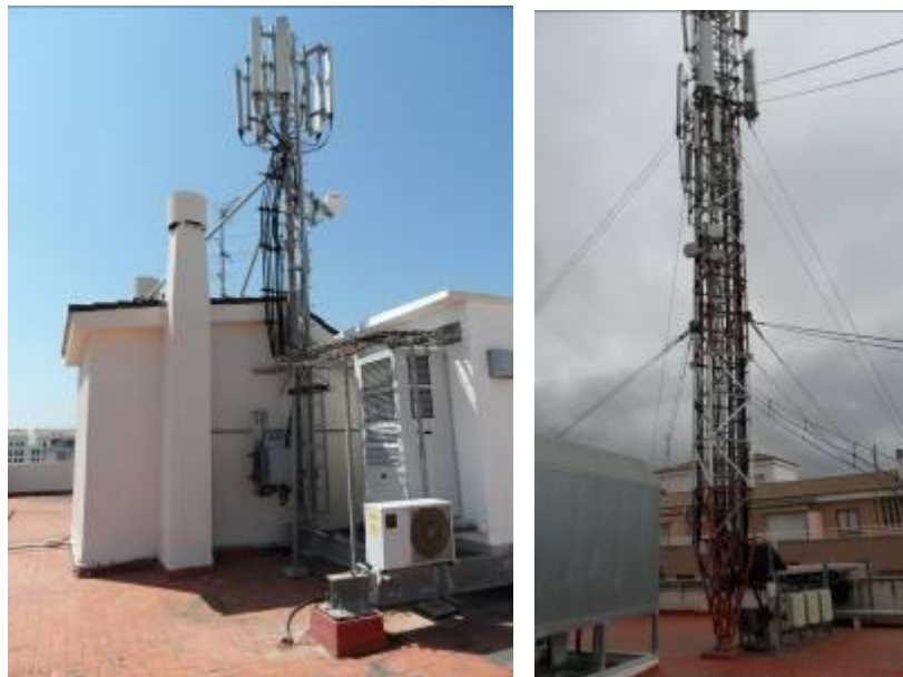
Figura 2. Ejemplos de emplazamientos urbanos, tanto instalaciones de antenas sobre mástiles en la azotea de un edificio de viviendas como torre sobre centro de transformación (CT).
