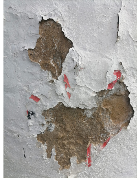
Fig. 44 Detalle de desperfecto del muro
