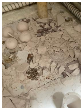
Fig. 55. Ruptura de azulejos en el horno.
