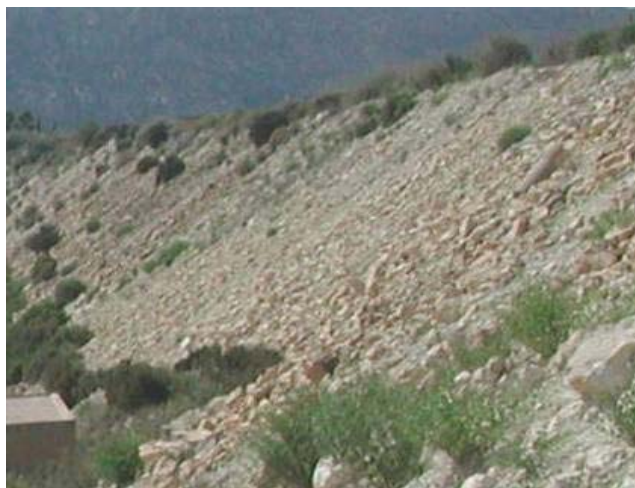
Figura V.2: Talud de una balsa desnudo o escasamente cubierto de vegetación espontánea.
