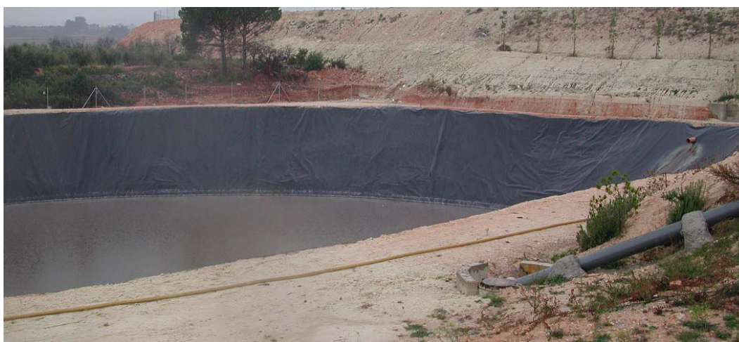
Figura 2.34: Vista parcial de la balsa de lixiviados de un vertedero de residuos no peligrosos.
