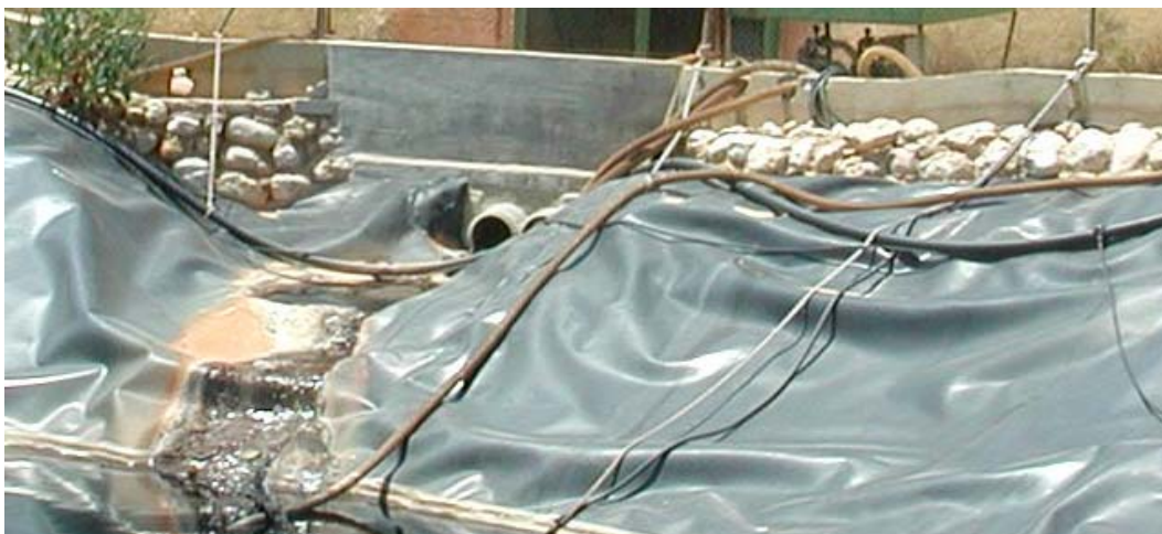
Figura 2.38: tubería de entrada con el líquido cayendo sobre la lámina, anclaje de lámina en coronación y vallado perimetral.
