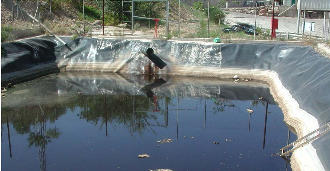
Figura 2.37: balsa de lixiviados con talud interior, impermeabilización y obras complementarias (tubería de entrada de HPDE, escalera de salvamento, vallado perimetral y anclaje de la tubería).
