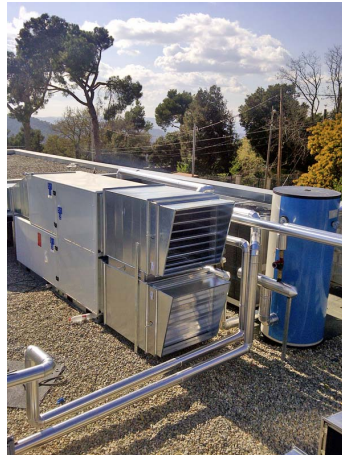
Figura 2: Vista de una UTA
