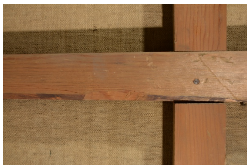
Figura 41. Faltant en el travesser.
