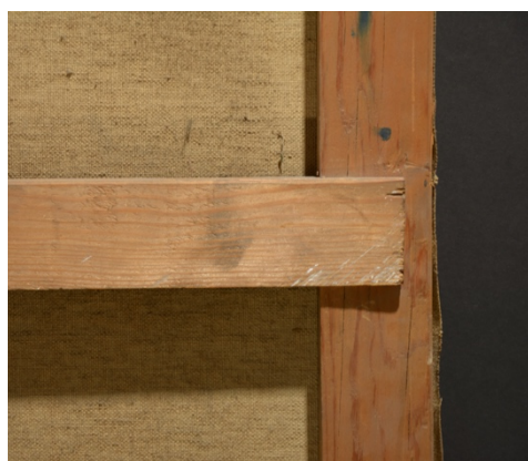
Figura 40. Detall de les taques de pintura i esguitaments blanquinosos.
