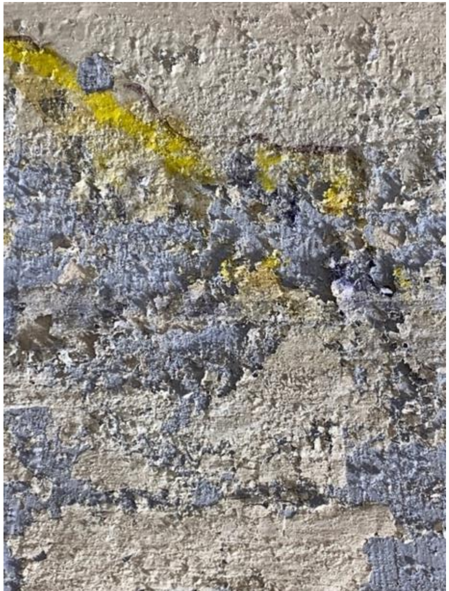
Fig. 67. Pulverulencia y delaminación, 3.
