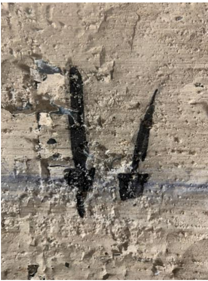
Fig. 65. Pulverulencia y delaminación, 1.
