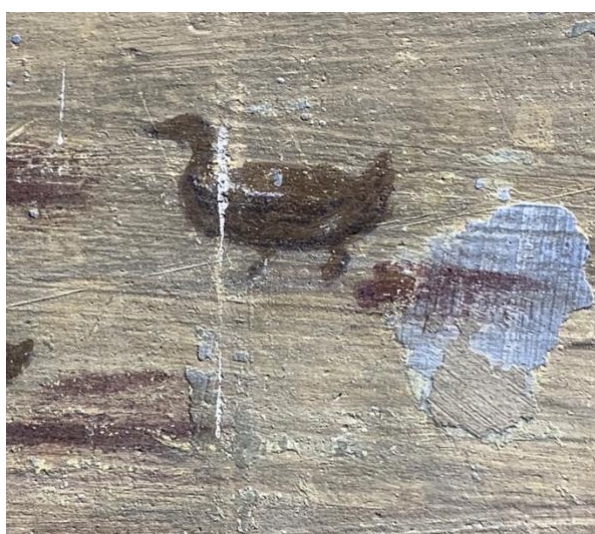
Fig. 68. Cambios de color por manchas de humedad.
