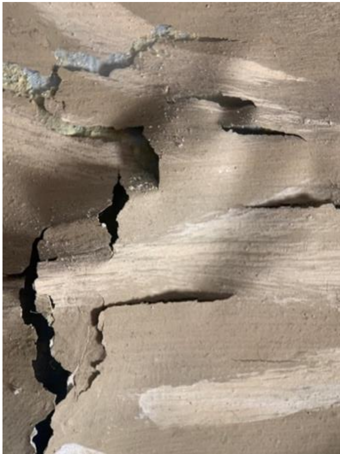
Fig. 62. Levantamientos y delaminación de la zona.
