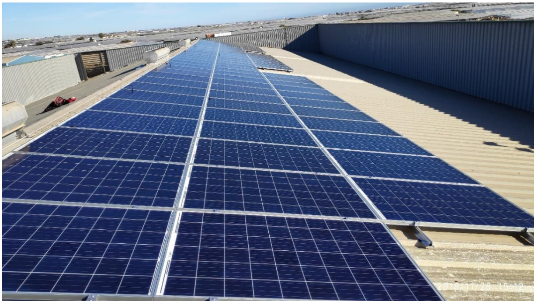
Imagen 4: Estructura coplanar sobre la cubierta inclinada de una nave industrial.
