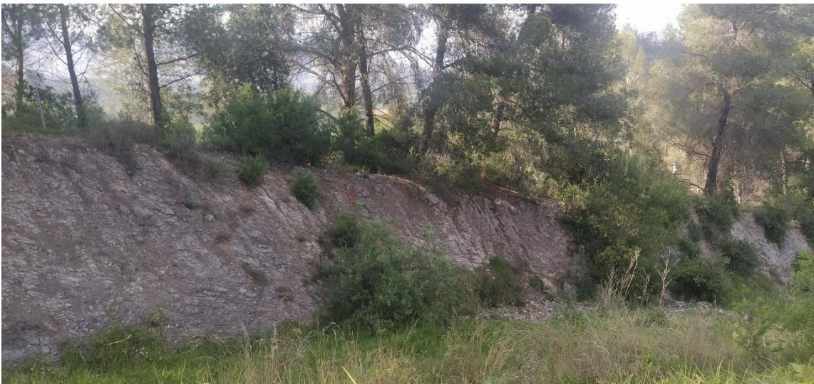
Figura 1. Talud de dolomías. Fuente: Elaboración propia.
