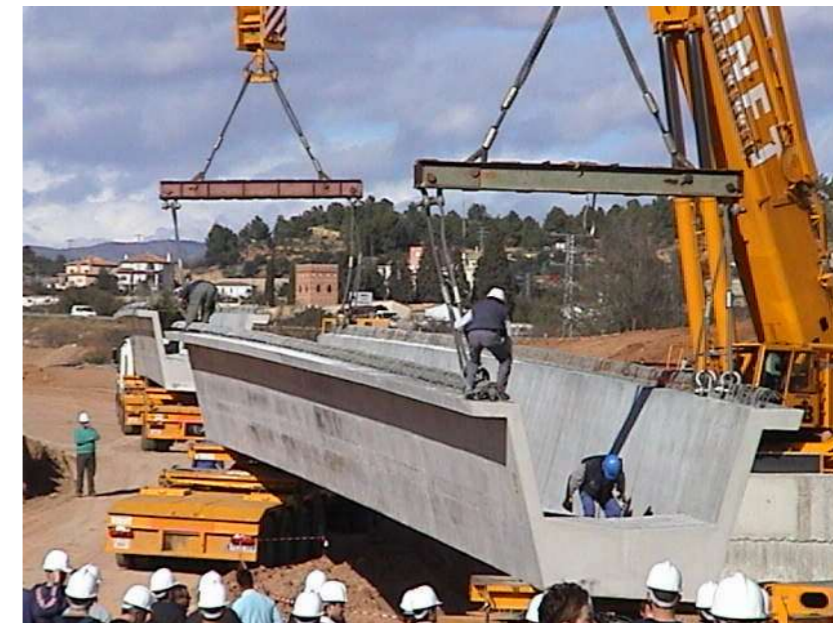
Figura 11. Viga siendo izada con dos grúas. Fuente: Blog de Víctor Yepes. https://victoryepes.blogs.upv.es/tag/gruas/
