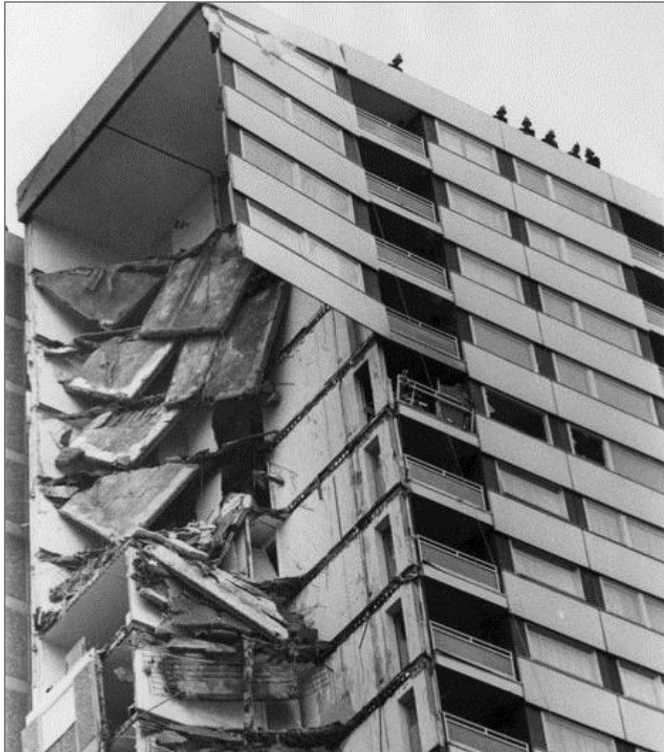
Figura 1. Ronan Point Tower tras el colapso parcial de la estructura.[2]
