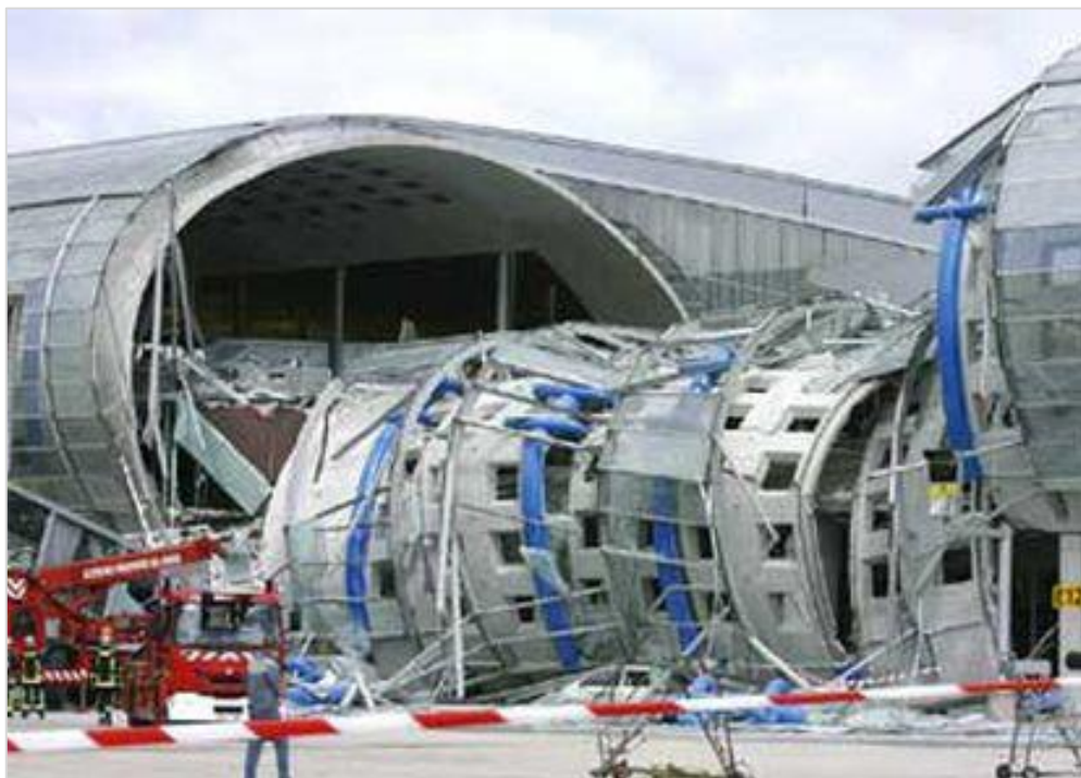
Figura 19. Desplome parcial de una pasarela en el Charles de Gaulle de París (2004) [17].
