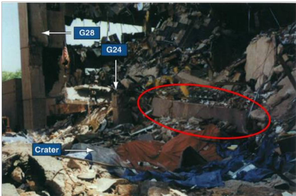
Figura 25. Fotografía de la zona donde explotó el artefacto tras el colapso en la que se observa una porción de la viga de gran canto intacta [22].
