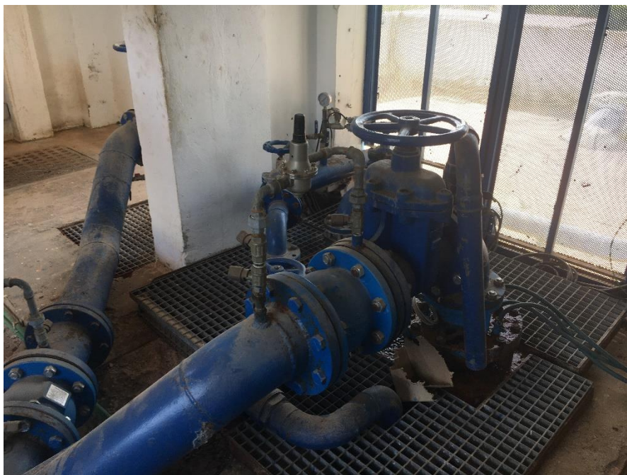
Imagen 1. Elevación a depósito de Cumbres, bomba cumbres 1 (73,5 kW)
