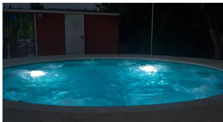
Figura 84 Encendido del sistema de aire con luces
