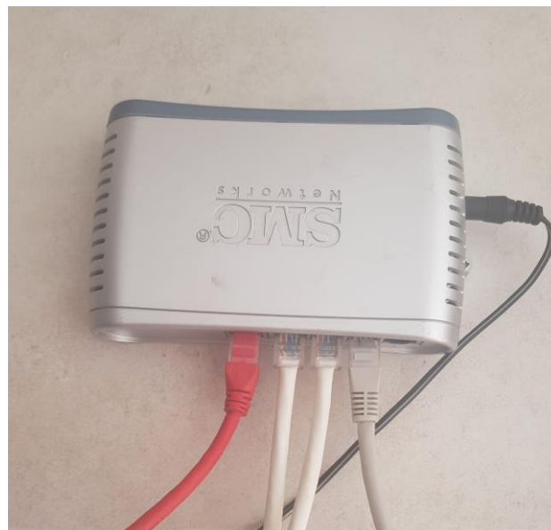
Figura 61 Switch con conexiones
