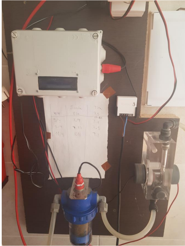
Figura 62 Sistema de control de pH y cloro de la piscina
