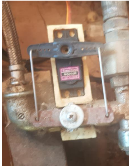
Figura 75 Conexiones servomotor con llave de paso
