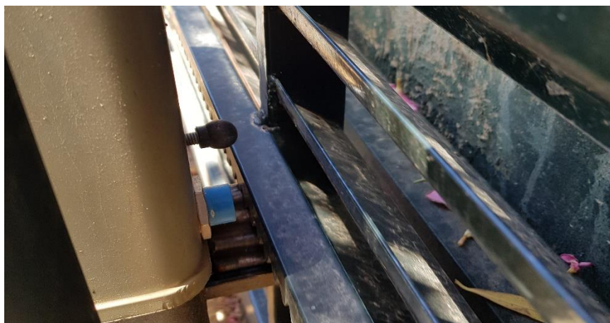
Figura 52 Sensor inductivo detectando puerta abierta
