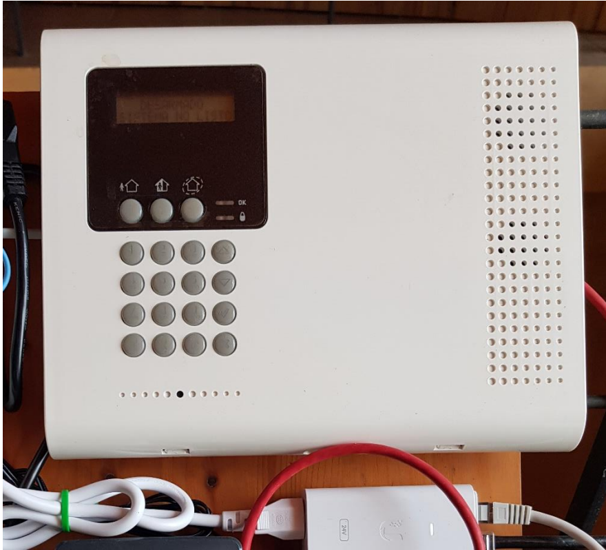
Figura 63 Central risco instalada en cuadro general de telecomunicaciones.
