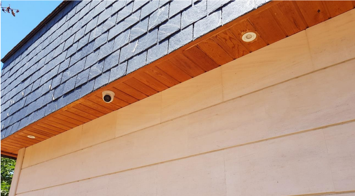
Figura 61 Cámara domo instalada en techo
