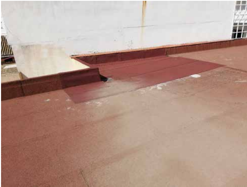
Imagen 23. Problema de pendientes en cubierta
