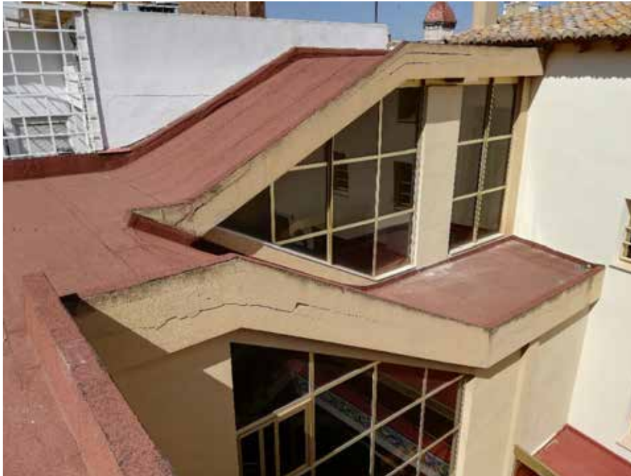
Imagen 15. Grietas a reparar en las fachadas del patio.
