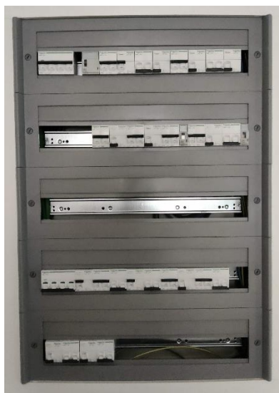
Imagen 1. Cuadro de recepción edificio ampliación.
