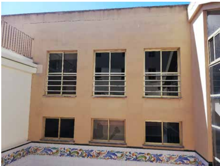
Imagen 16. Grietas a reparar en las fachadas del patio.
