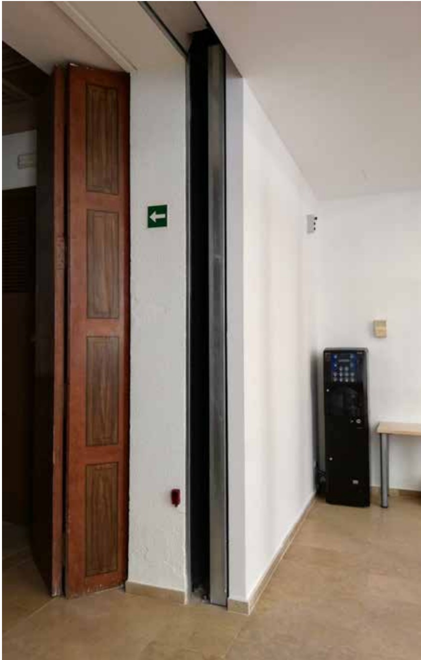
Imagen 3. Hueco existente entre la puerta de sector de incendios y el tabique.
