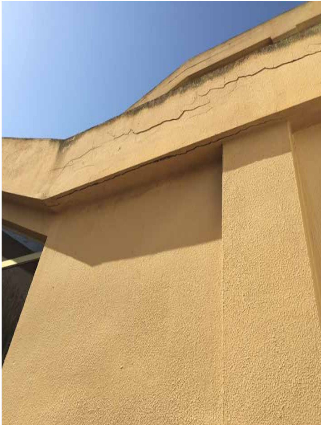
Imagen 14. Grietas a reparar en las fachadas del patio.
