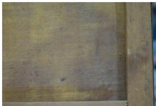
Fig. 43. Suciedad superficial del soporte.
