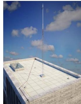
Ilustración 46: Anclaje a cubierta mediante torreta.
