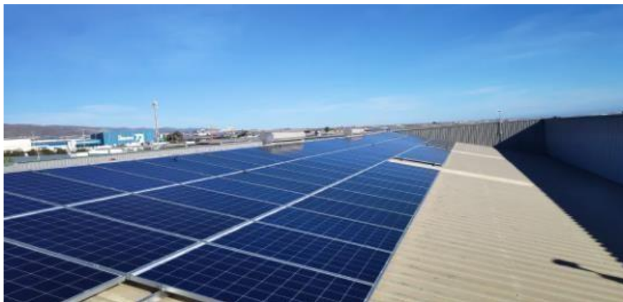
Figura 28 - Instalación fotovoltaica en la cubierta
