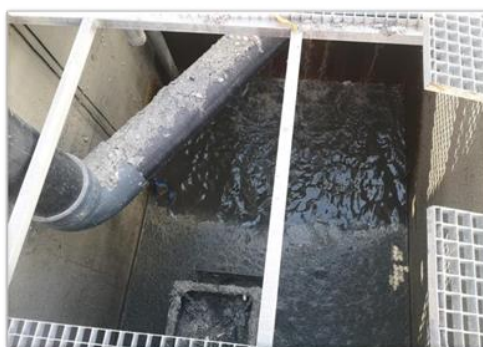
Figura 4. Pozo de bombeo 1
