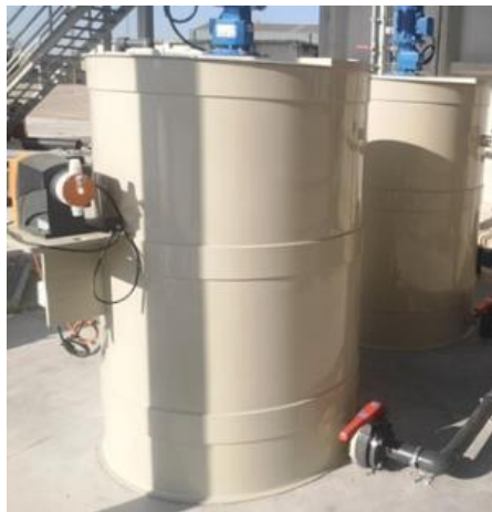
Figura 20. Planta de preparación de polielectrolito utilizado en el tratamiento de fangos
