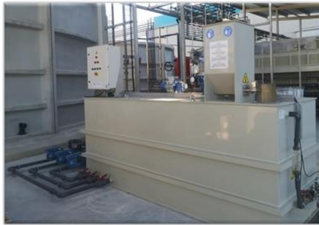
Figura 13. Planta de preparación del polielectrolito utilizado en el tratamiento primario
