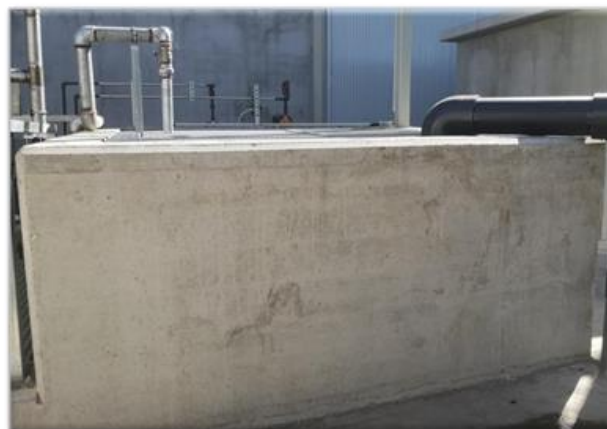
Figura 12. Pozo de aguas reutilizadas
