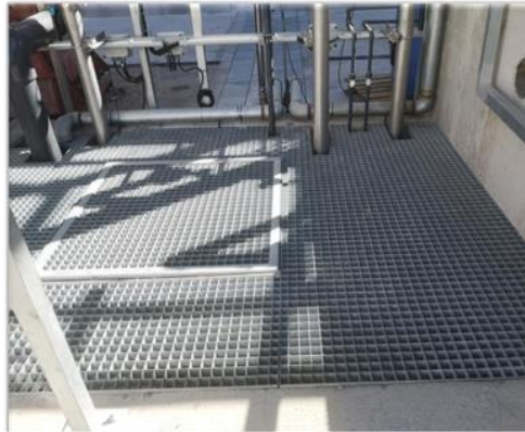
Figura 6. Pozo de bombeo 2
