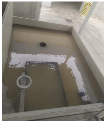
Figura 10. Cámara de aguas claras
