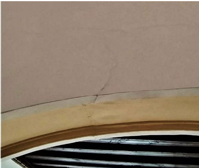
Imagen 9.1.20 Grieta en el arco de la entrada. Vista 3
