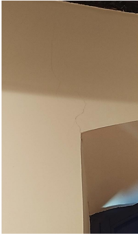
Imagen 9.1.22 Grieta en esquina de hueco
