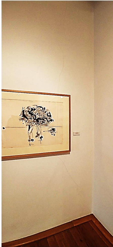
Imagen 9.1.21 Grieta en esquina de estancia
