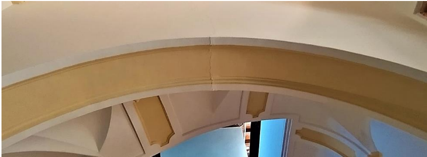
Imagen 9.1.19 Grieta en el arco de la entrada. Vista 2
