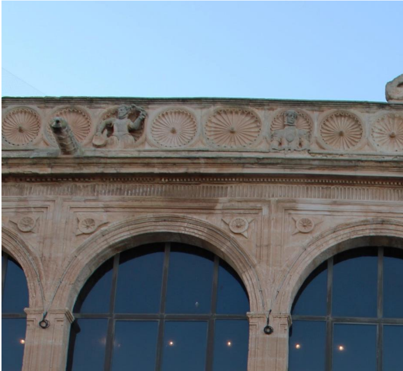
Imagen 9.1.7 Mancha de humedad localizada en la fachada principal
