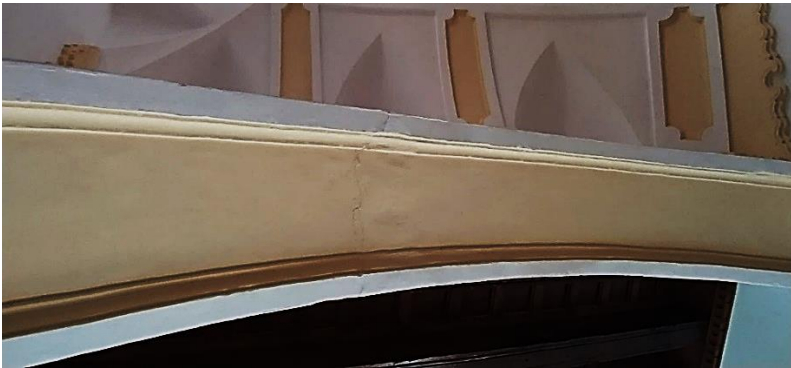
Imagen 9.1.18 Grieta en el arco de la entrada. Vista 1
