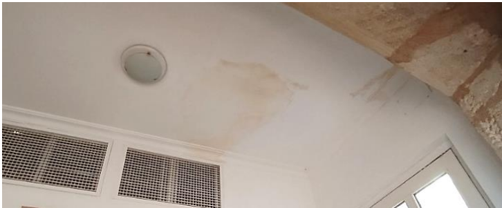
Imagen 9.1.1 Mancha de Humedad
