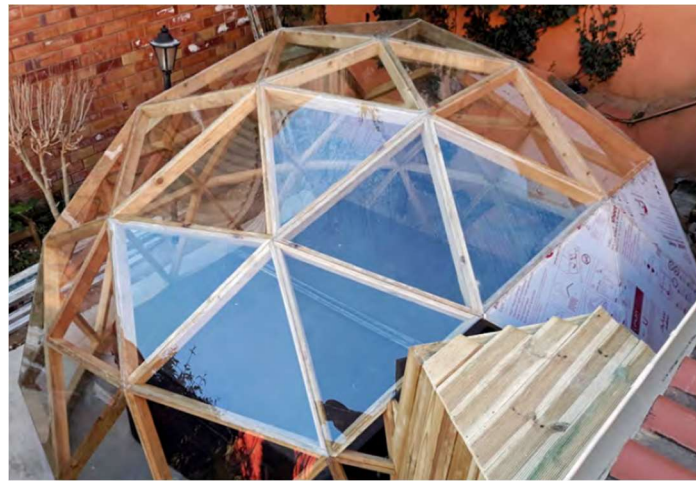
Ilustración 19. Ejemplo de domo cubierto con policarbonato compacto.
