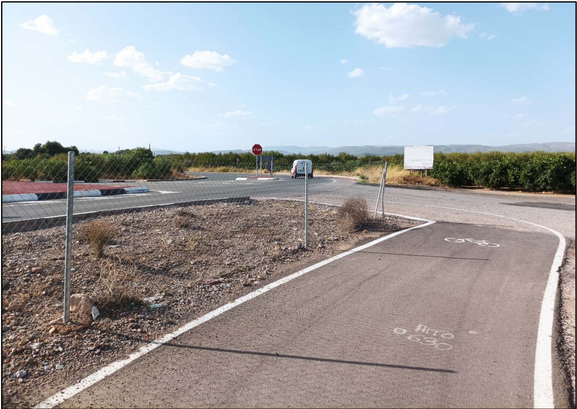
Foto 33. Ejemplo de valla de cerramiento de malla metálica de simple torsión como cercado del dominio público viario Fuente: Elaboración propia
