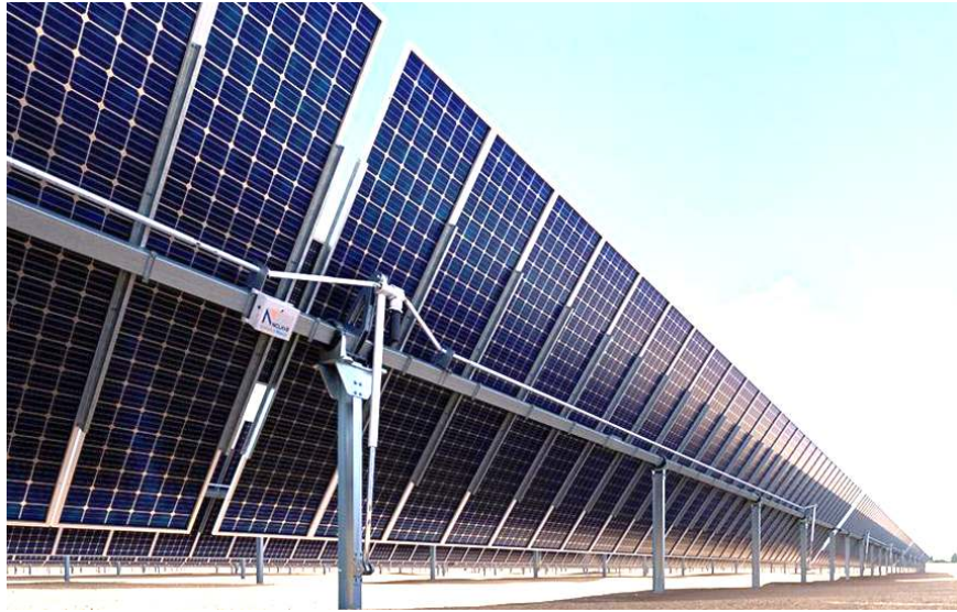
Figura 17 Estructura de seguidor solar d'un sol eix [8]
