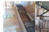
5. NTE-EHZ Escaleras 46 Pines · 4 subtableros 4 sem
