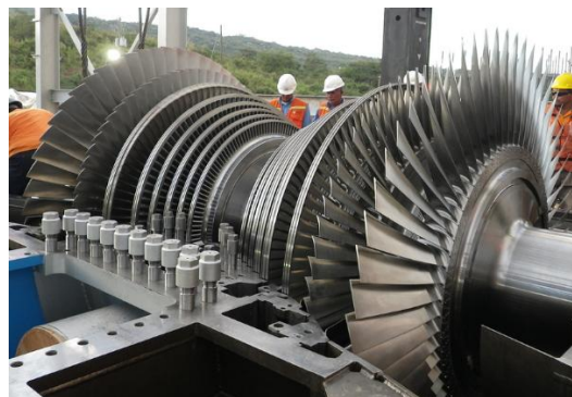
Figura 29. Detalle de una turbina de vapor en proceso de instalación en la central geotérmica de San Jacinto Tizate, en Nicaragua. Fuente: ORMAD, A. (2012). Novedades en el proyecto de San Jacinto Tizate .
