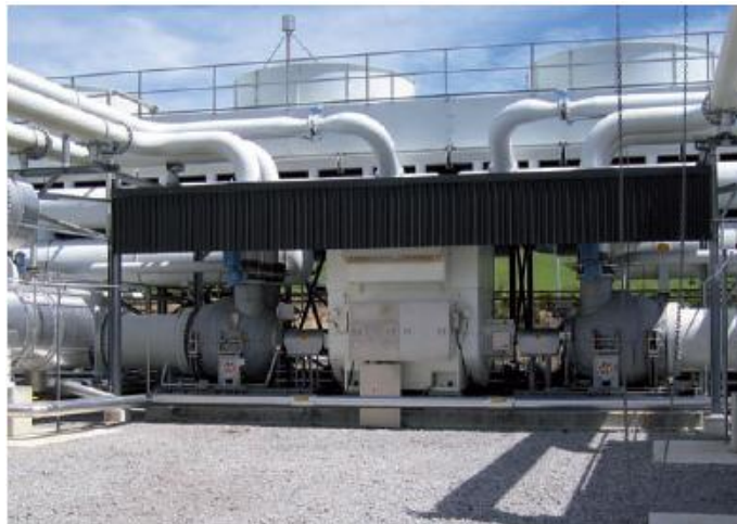
Figura 4. Central geotérmica de ciclo binario, Mokai 2, en Nueva Zelanda. Fuente: IDAE, IGME (2008). Manual de Geotermia .
