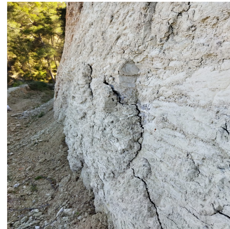
Ilustración 28. Fisuras de las margas en la zona de la berma. Fuente: Elaboración propia.
