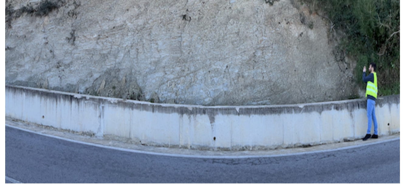
Ilustración 32. Muro de protección y contención del material desprendido. Fuente: Elaboración propia.
