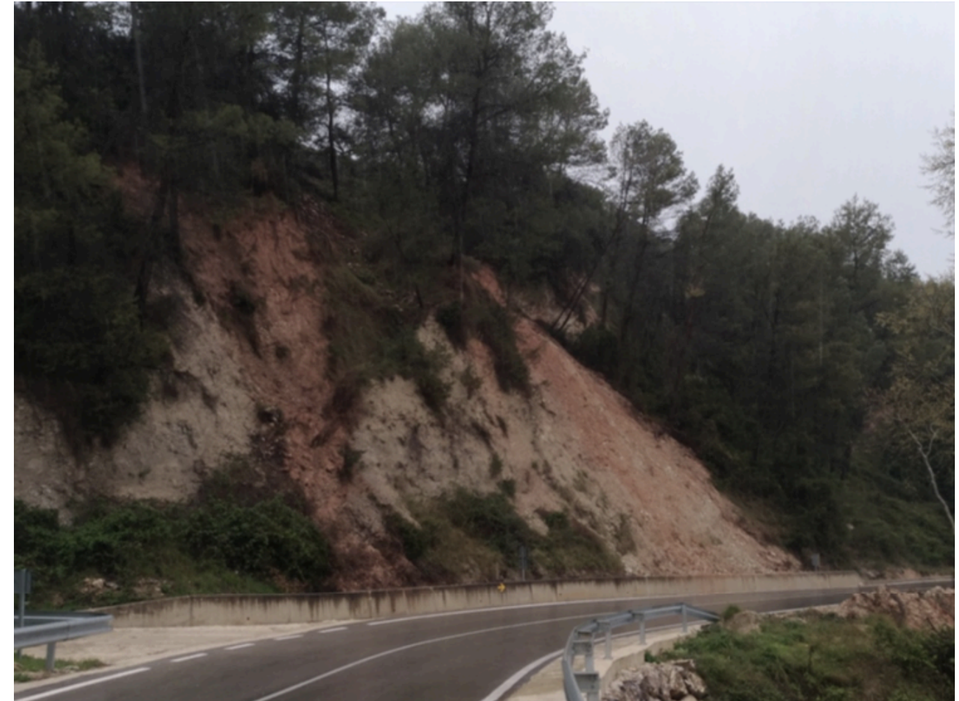
Ilustración 2. Detalle del deslizamiento del talud. Fuente: Memoria Valorada "Acondicionamiento del talud del P.K. 1+980 de la CV-652. T.M. Moixent (Valencia).
