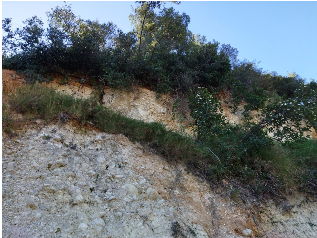
Ilustración 29. Coluvión de gravas en la zona superior del talud. Fuente: Elaboración propia.
