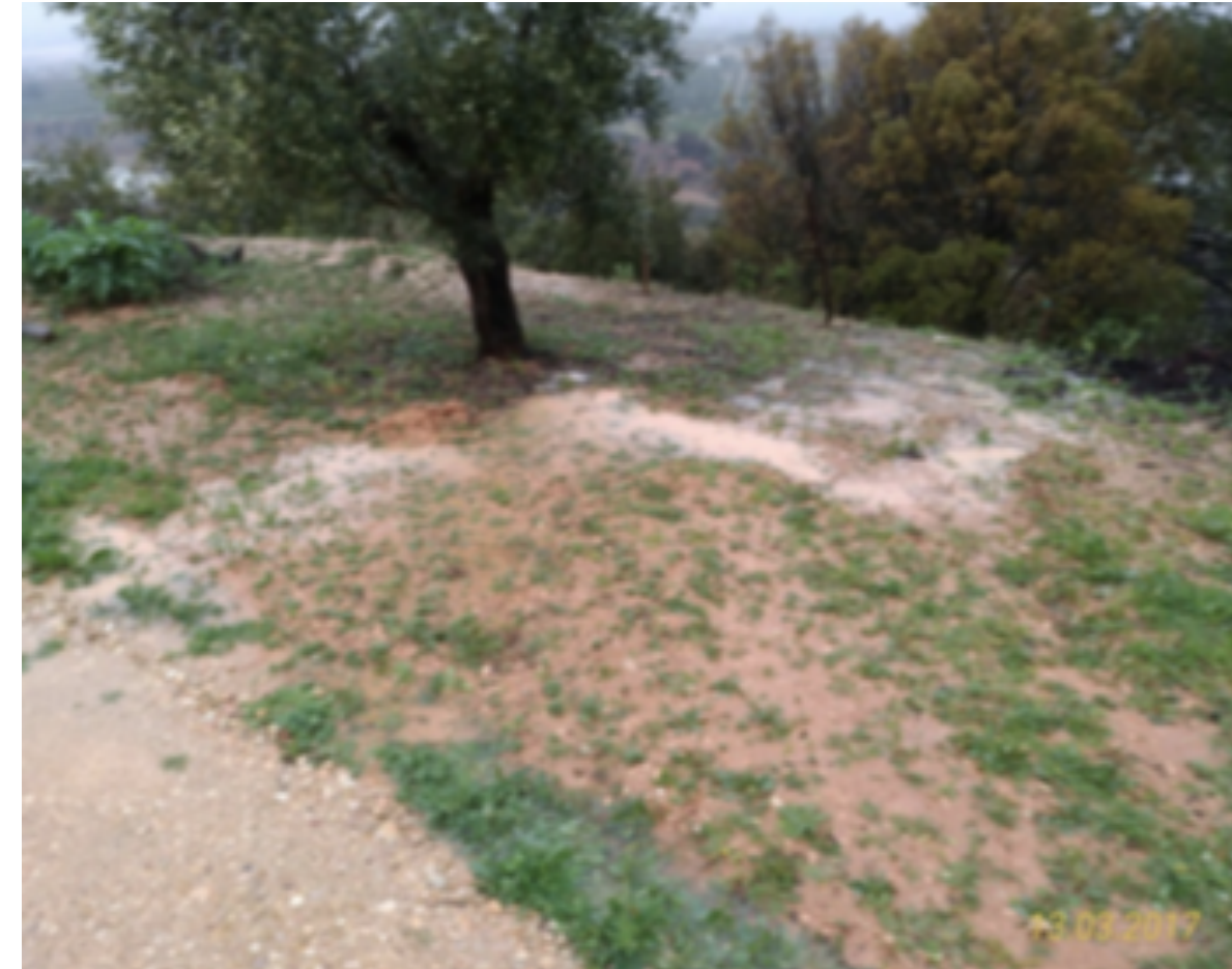
Ilustración 54. Vista del terreno de la cabeza del talud. Fuente: Memoria Valorada "Acondicionamiento del talud del P.K. 1+980 de la CV-652. T.M. Moixent (Valencia).
