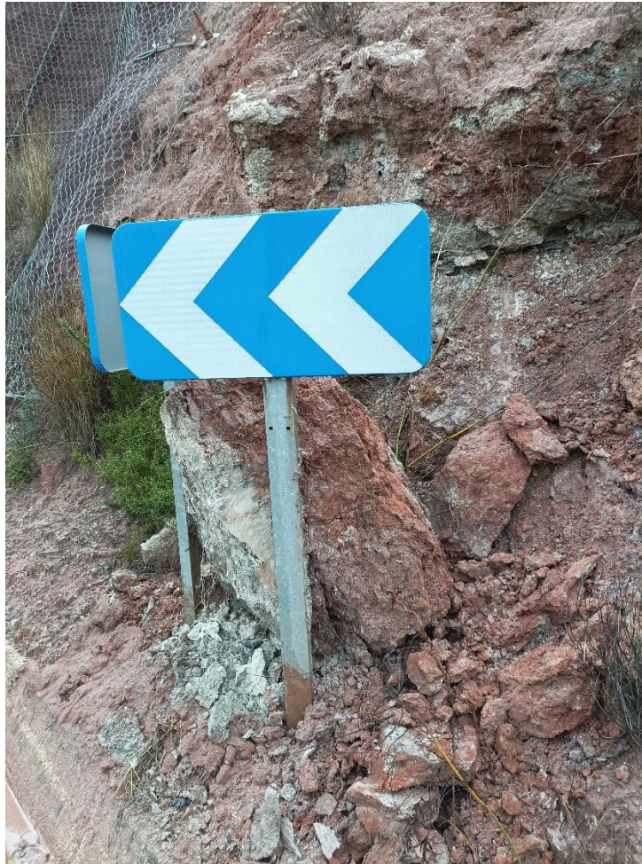
Figura 31: Desprendimiento en dos señales de balizamiento. Fuente: Propia.
