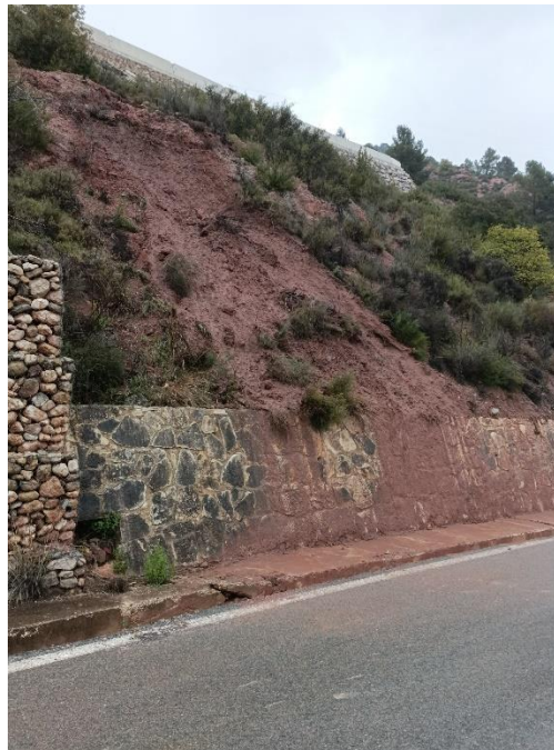
Figura 4: Deslizamiento sobre muro de escollera. Fuente: Propia.
