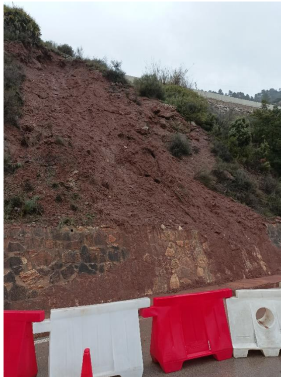
Figura 22: Deslizamiento cercado. Fuente: Propia.
