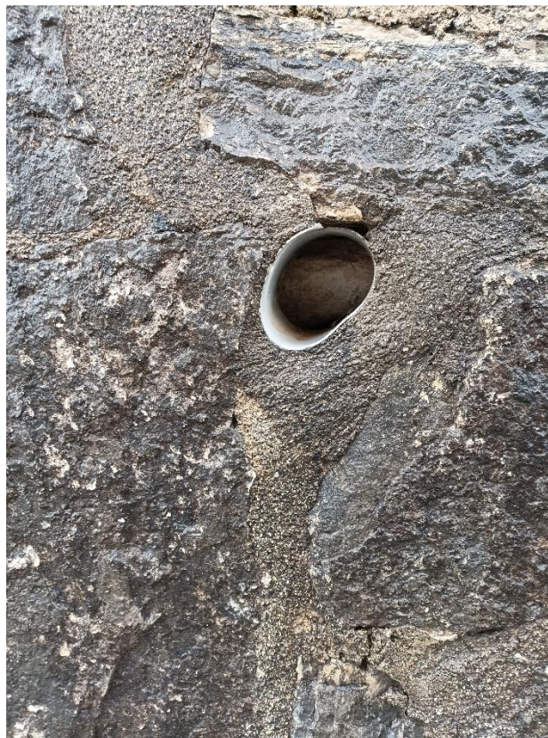
Figura 27: Drenaje de muro escollera. Fuente: Propia.
