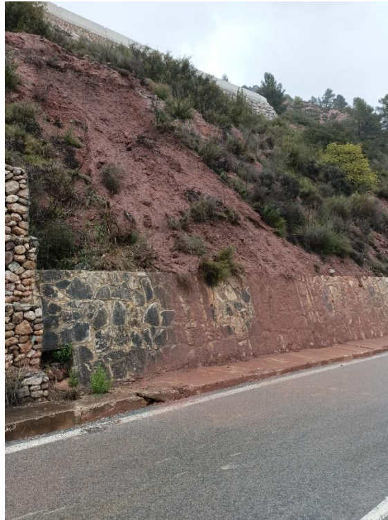
Figura 23: Deslizamiento. Fuente: Propia.
