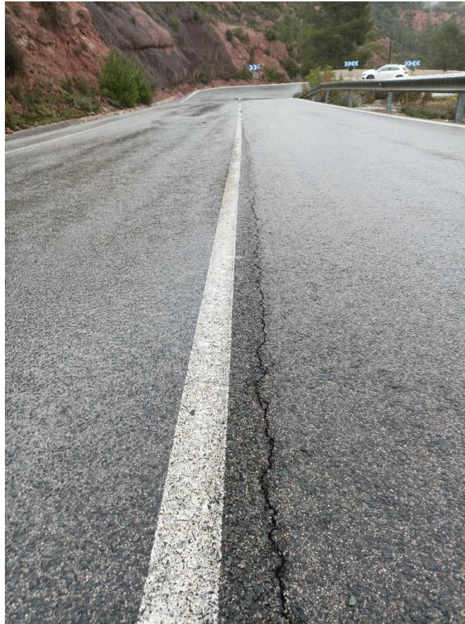
Figura 36: Fisuras en la carretera. Fuente: Propia.
