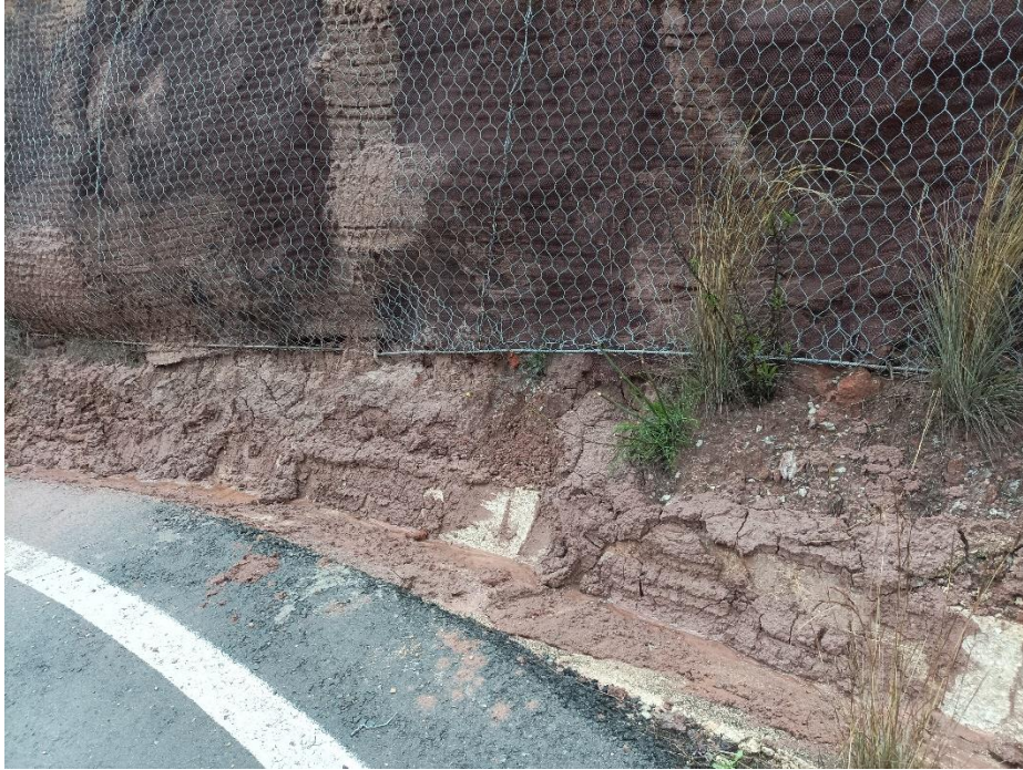
Figura 30: Colmatación de un drenaje. Fuente: Propia.
