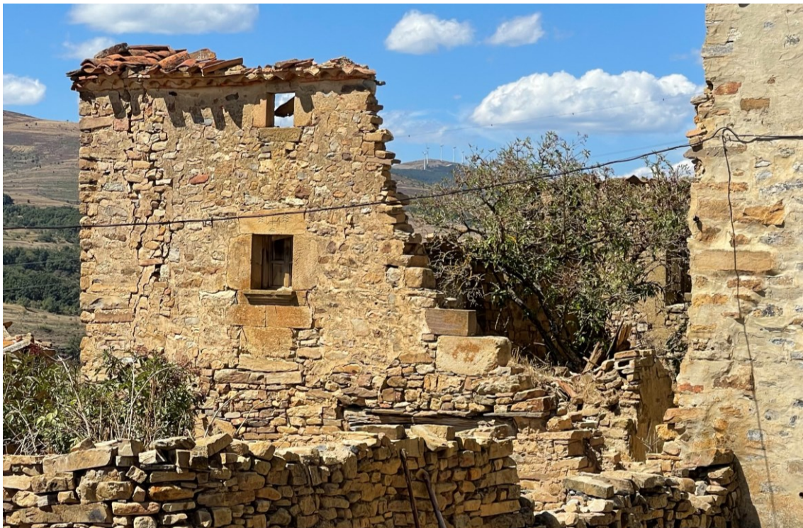
Imagen 10. Vivienda en ruinas Las Aldehuelas, Soria. Fuente: Elaboración propia (2022)
