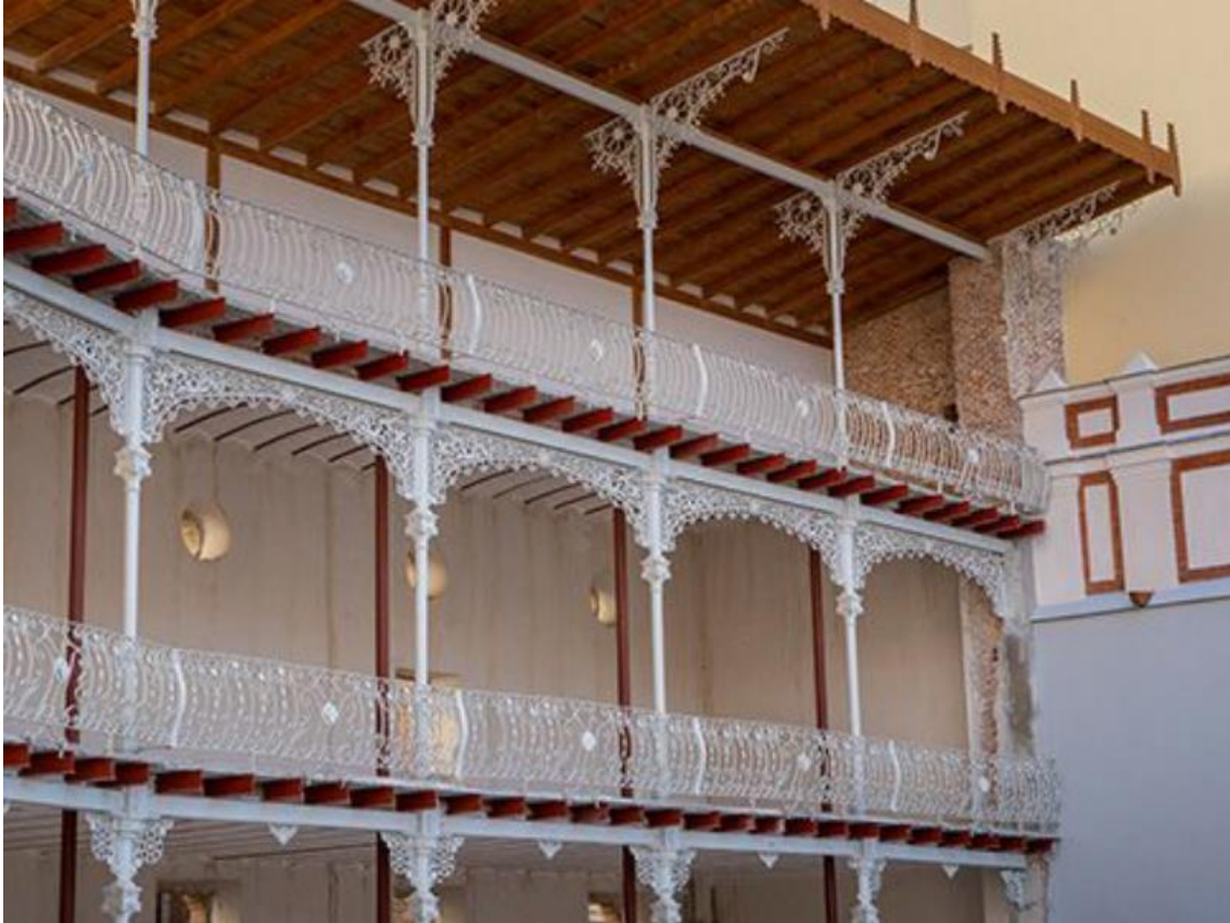
Figura 5. Reconstrucción de las barandillas y rejerías en el frontón Beti Jai de Madrid
