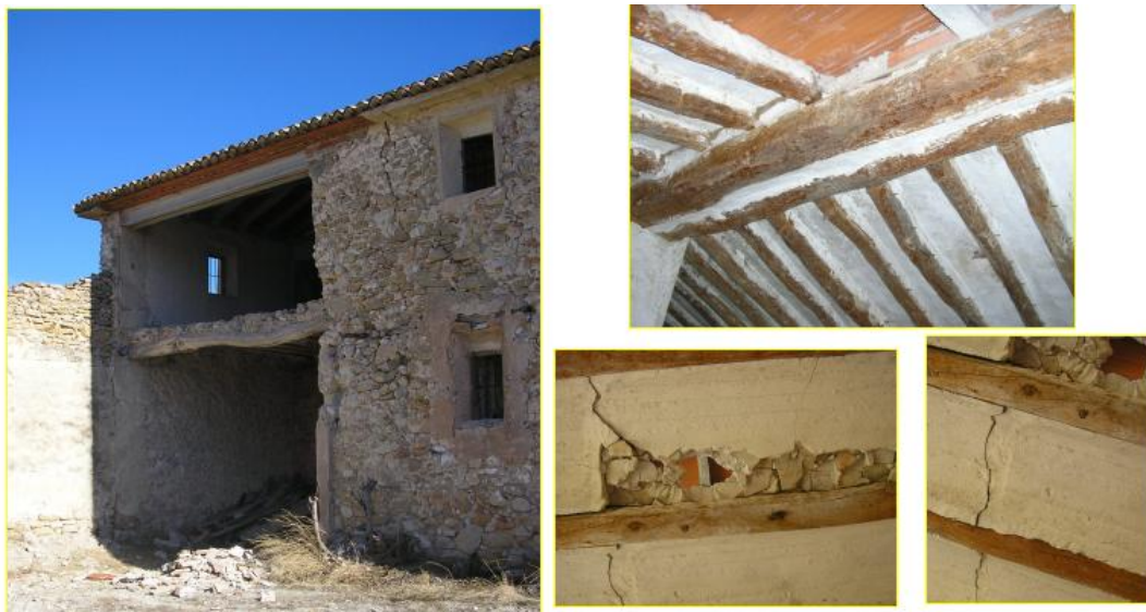
Figura 15: Vistes de l'enderrocament de la façana (figura esquerra), del mal estat de conservació del forjat (figures inferiors dreta) i de la coberta (figura superior dreta)
