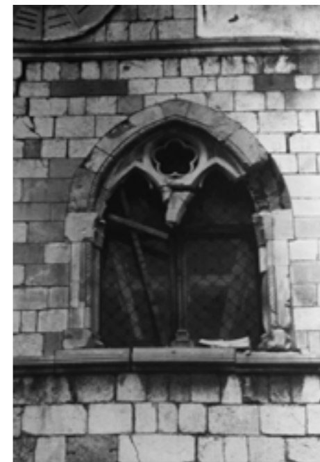
91_Detalle de la ventana después del terremoto
