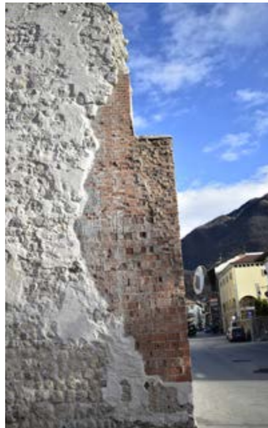
59_Señalización mediante uso de otro material
