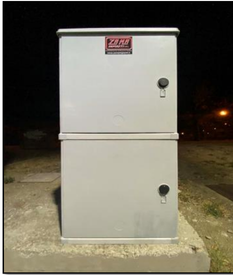
Figura 30: Caja de control del sistema de iluminación. Fuente: Facoltà d'Ingegneria dell'Università di Bologna
