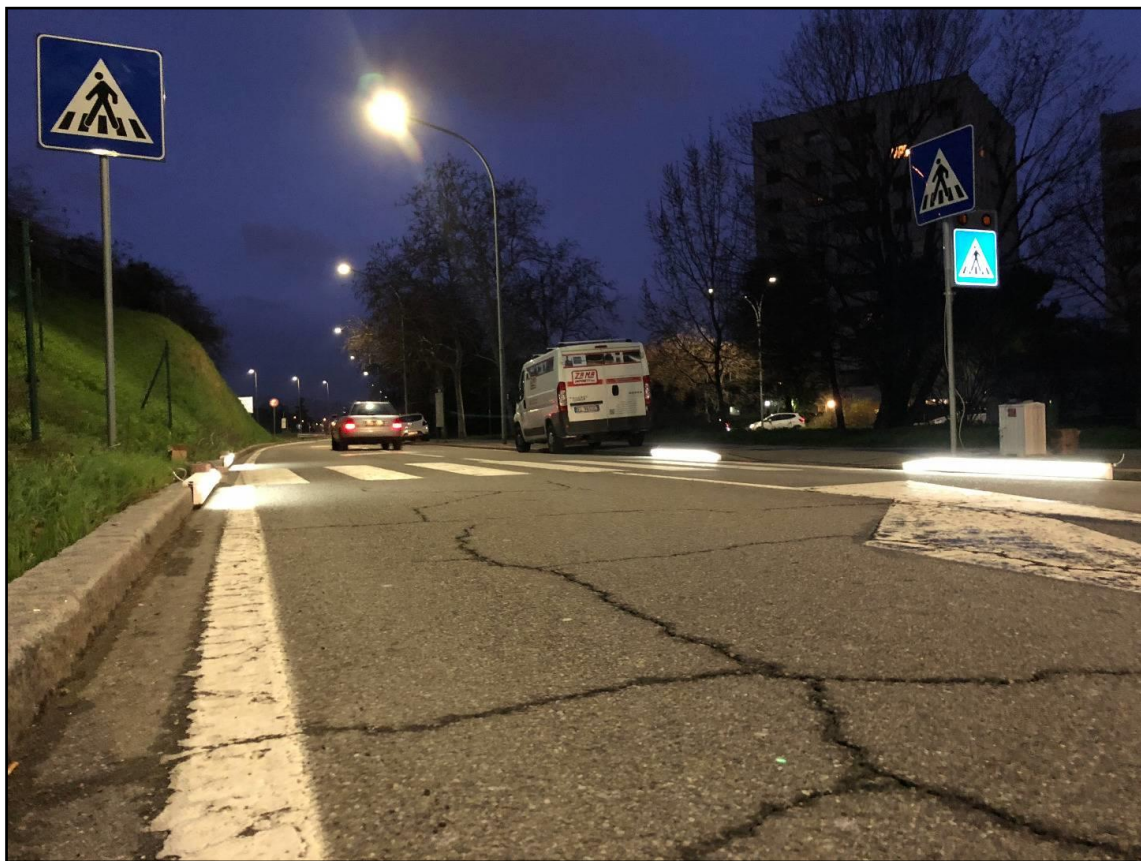
Figura 25: Sistema LookAtMe en estado de prueba en Bologna. Fuente: http://www.zamaimpianti.it/
