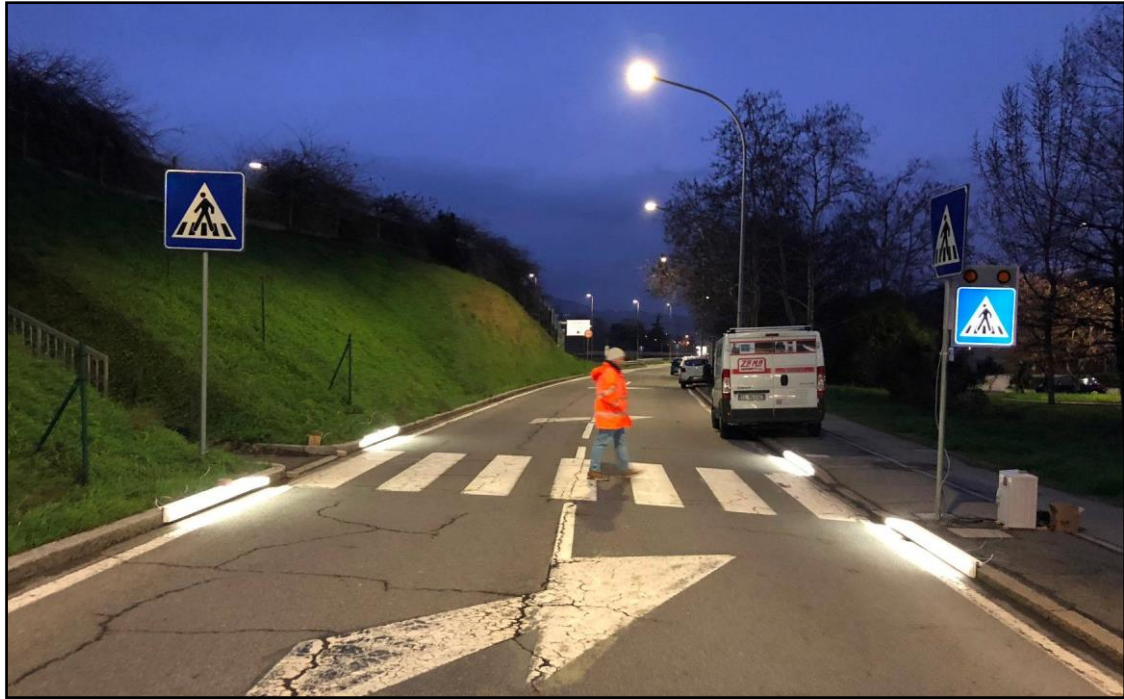
Figura 24: Sistema LookAtMe en estado de prueba en Bologna. Fuente: http://www.zamaimpianti.it/
