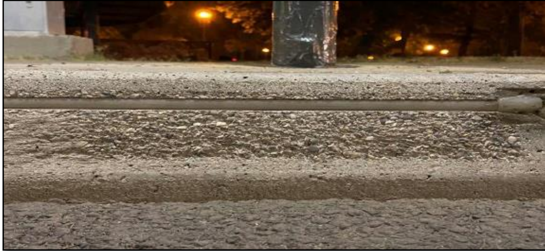
Figura 21: Bordillo de hormigón con el sistema Lookatme en el cruce peatonal de via Andrea Costa. Fuente: Elaboración propia
