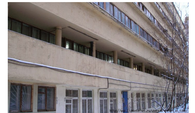
Fig. 38. Planta baja del bloque principal después de las alteraciones sufridas que no corresponden al proyecto original.
