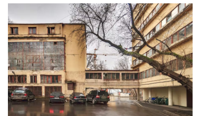
Fig. 39. Estado de deterioro del edificio previo al proyecto de recuperación y reforma integral del proyecto.
