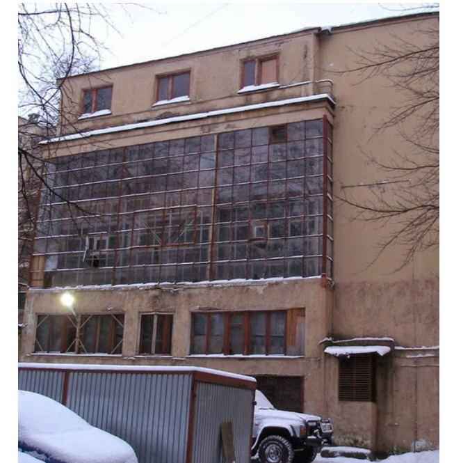
Fig. 37. Edificio anexo de usos comunes después de las alteraciones sufridas que no corresponden al proyecto original.
