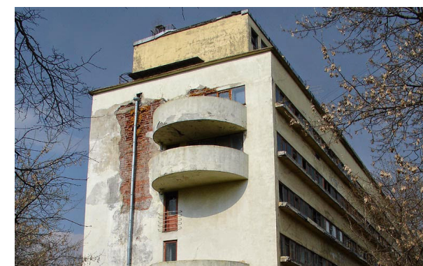
Fig. 36. Estado de deterioro del edificio previo al proyecto de recuperación y reforma integral del proyecto.
