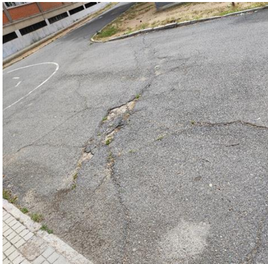
Figura 7: Boquete en el suelo del patio (junio 2022)
