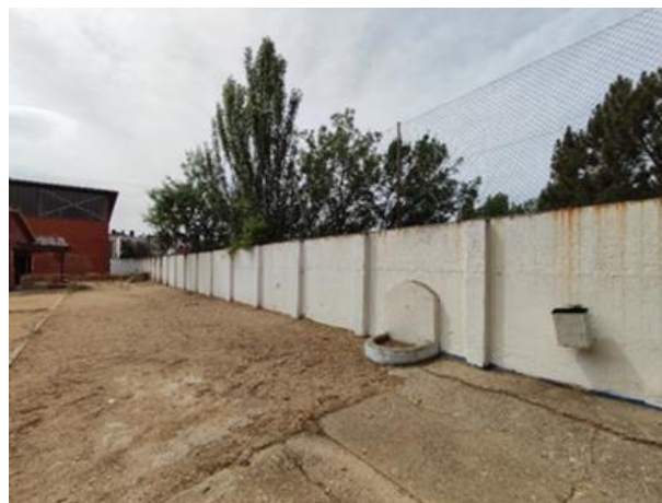
Figura 9: Pared y verja superior límite del patio en mal estado (junio 2022)
