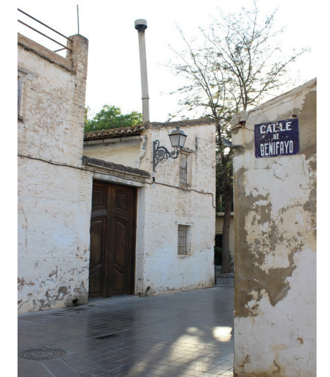
Fig. 5.2. Vivienda en deterioro en el barrio de Campanar en Valencia (Desconocido)
