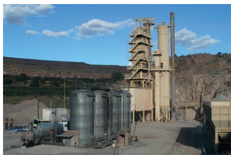
Figura 1.6. Planta de aglomerado asfáltico en caliente.
